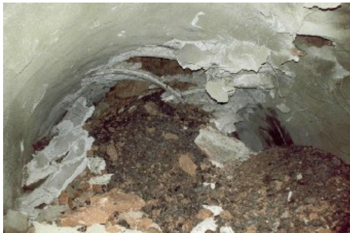
Εικόνα 2.8: Αργιλικός Σχηματισμός - Νότιο Μέτωπο: Οι πιέσεις στο κέλυφος της σήραγγας οδήγησαν σε θραύση του θόλου της σήραγγας σε μήκος 40m [21]
