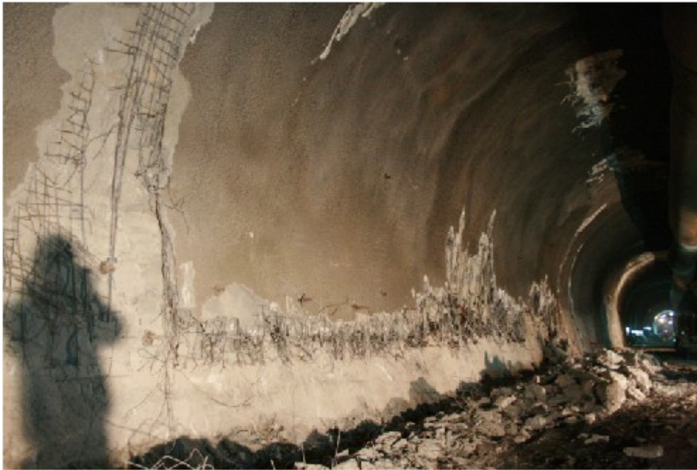
Εικόνα 4.4: Νότιο μέτωπο - Αστοχία σε Σχιστώδη Σερπεντινίτη [21]
