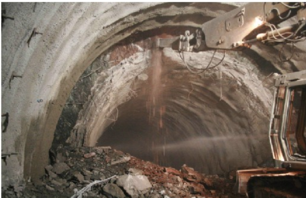
Εικόνα 4.1: Νότιο Μέτωπο - Σχιστώδης Σερπεντινίτης. Αστοχία προσωρινής υποστήριξης λόγω συγκλίσεων [21]
