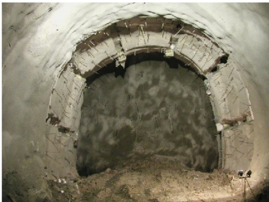
Εικόνα 4.3: Παράδειγμα κατασκευής της διατομής ενδοτικού τύπου στον αργιλικό σχηματισμό στο νότιο μέτωπο [21]
