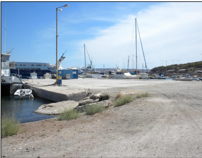
Εικόνα 5.4: Κατεστραμμένα σε ορισμένα σημεία κρηπιδώματα
