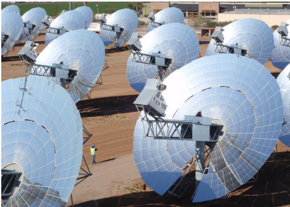
Σχήμα 4. 1 Εγκατάσταση συστημάτων ηλιακού δίσκου (28)
