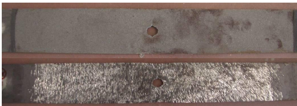
Σχήμα 4.1: Επιφάνεια του χάλυβα μετά την αποκόλληση του επιθέματος (προετοιμασία επιφάνειας με αμμοβολή, πάνω και αεροματσάκονο, κάτω).
