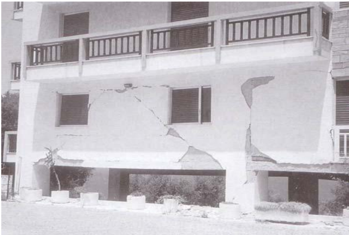
Σχ. 1.3 Ζημίες από σεισμό σε τοιχοποιία
