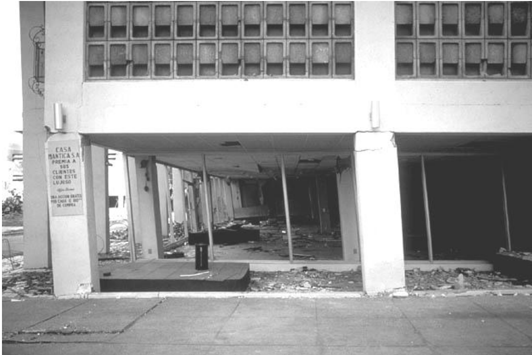
Σχ. 1.4: Αστοχία στη βάση υποστυλωμάτων pilotis
