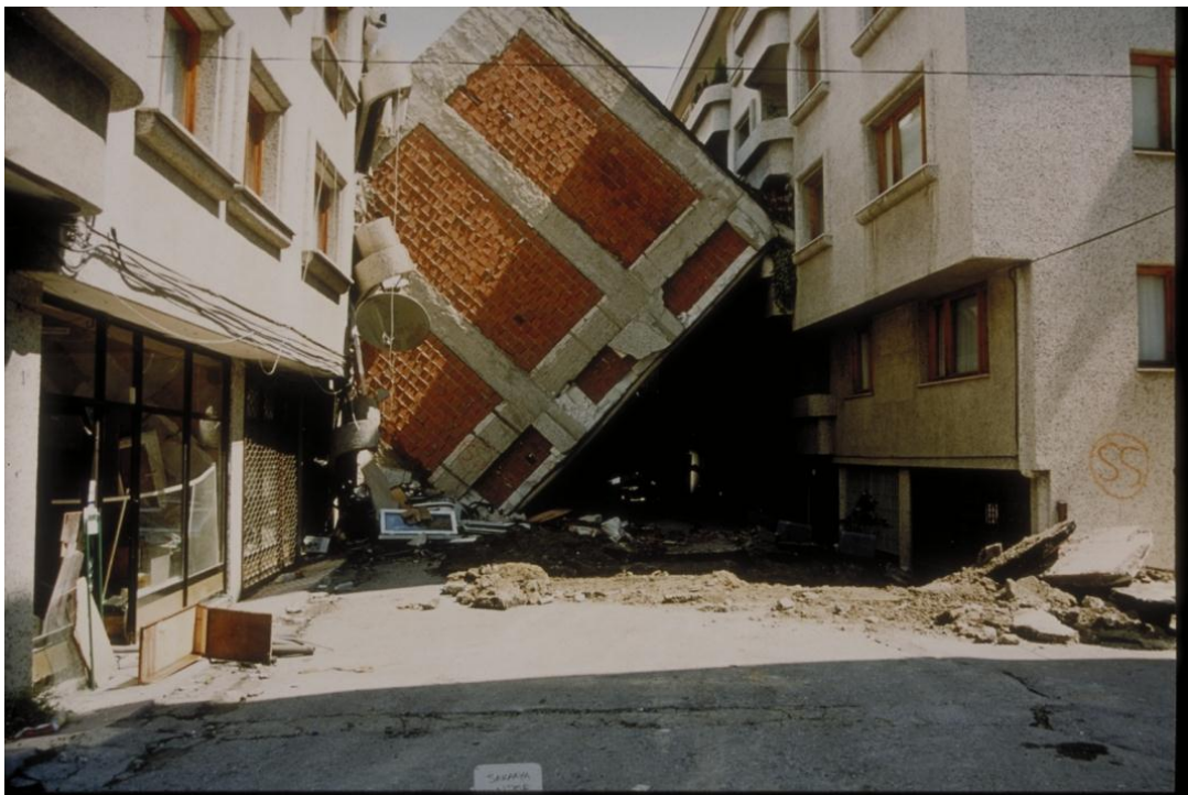
Σχ. 1.5: Ανατροπή κτηρίου μετά από σχηματισμό μηχανισμού πλαστικού ορόφου στον 1 ο όροφο
