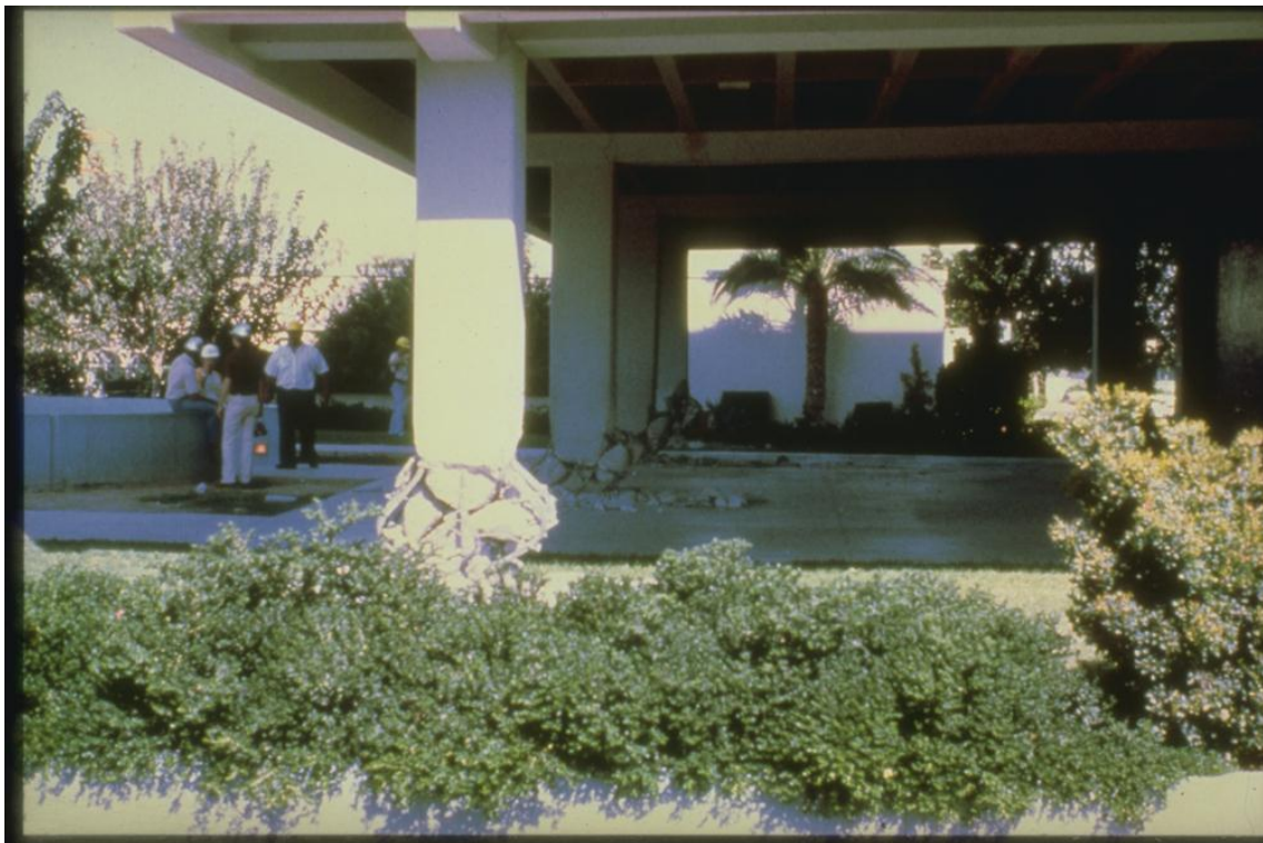
Σχ. 1.1: Αστοχία στη βάση υποστυλωμάτων pilotis
