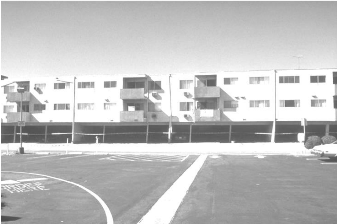
Σχ. 1.6: Αστοχία με σχηματισμό πλαστικού ορόφου σε pilotis
