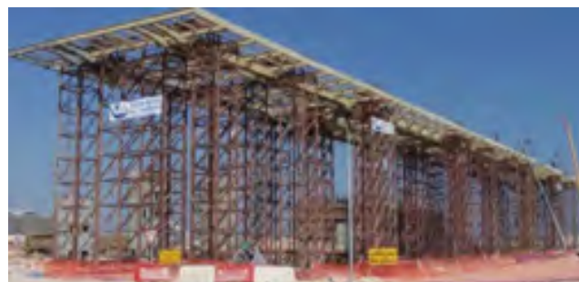
Εικόνα 71. Το πρώτο στάδιο κατασκευής του έργου είναι η ανέγερση του ξυλότυπου του υποστέγου.
