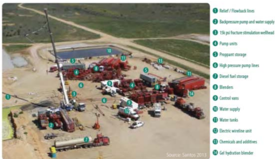
Εικόνα 4.3.: Εργοταξιακός χώρος στην Αυστραλία με τον απαραίτητο εξοπλισμό, για την επικείμενη εφαρμογή της μεθόδου της υδραυλικής ρωγμάτωσης, εγκατεστημένο (Santos, 2013)
