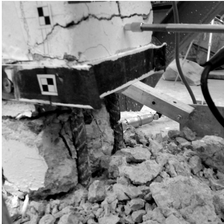
Εικόνα 7.29 Θράυση του εφελκόμενου οπλισμού
