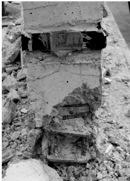
Εικόνα 7.20 Ελαφρύς λυγισμός των διαμήκων θλιβόμενων ράβδων
