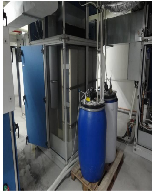
Σχήμα 2.17 Δεξαμενές συγκέντρωσης υγρού ξηραντικού
