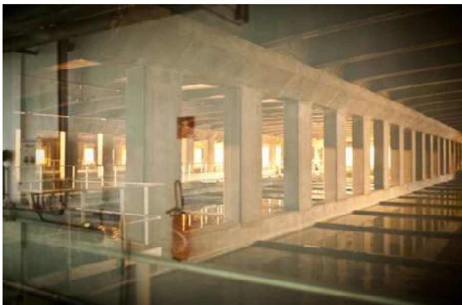
Εικόνα 5: Άποψη του εσωτερικού χώρου των υπόγειων δεξαμενών επεξεργασίας του Genolide STP
