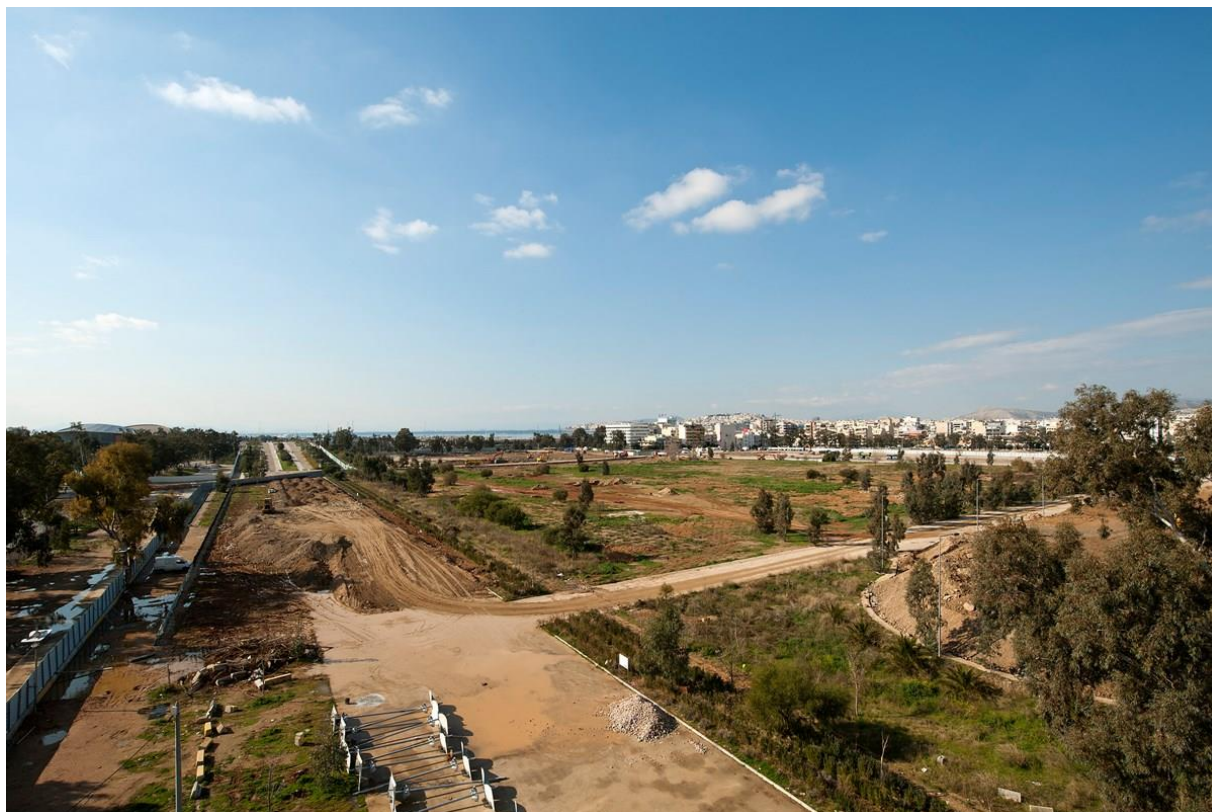
Εικόνα 10 - Άποψη του οικοπέδου από τη βορειοανατολική γωνία προς τη νοτιοδυτική. (Πηγή: http://www.snfcc.org/multimedia/construction-photos/?lang=el )
