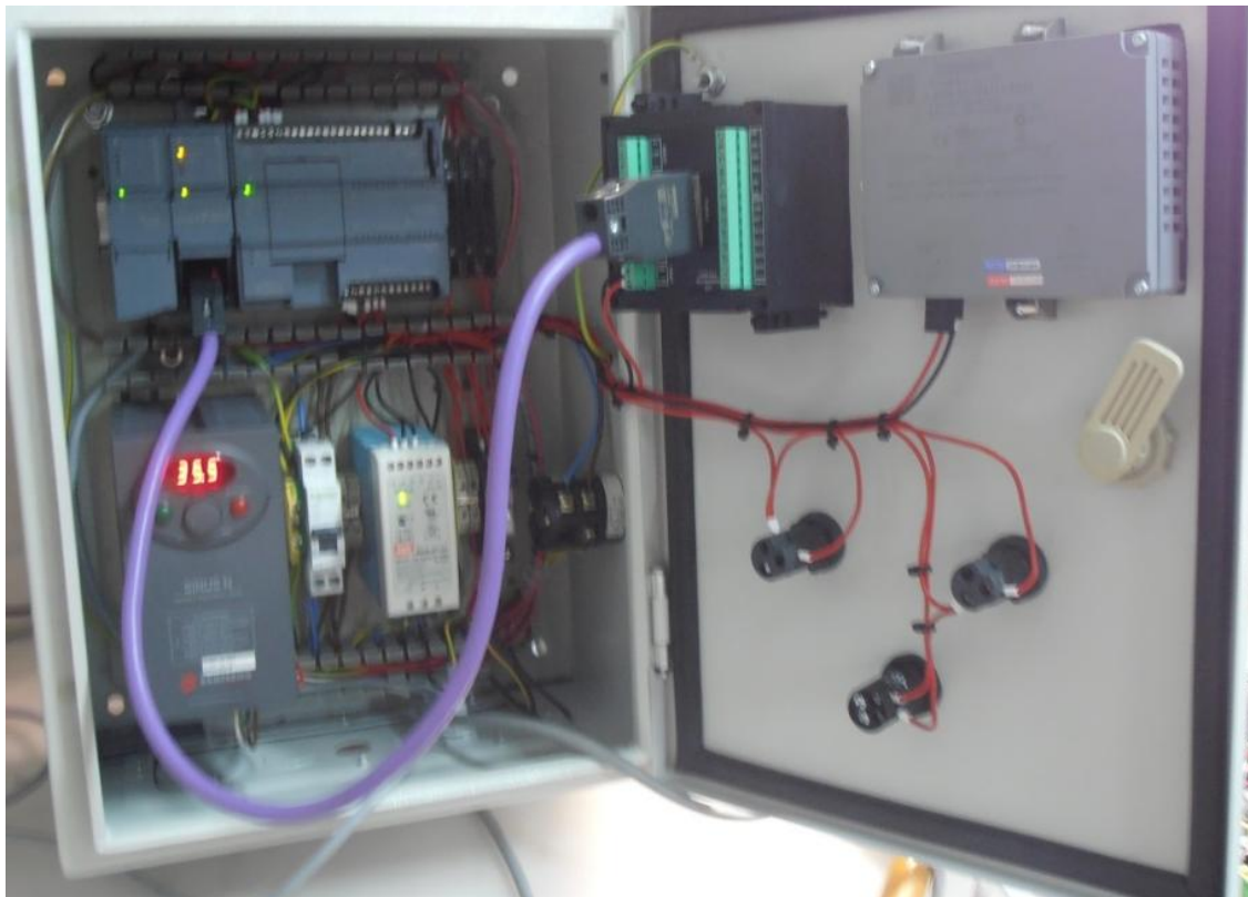
Εικόνα 5.1 : Το εξωτερικό και το εσωτερικό του πίνακα αυτοματισμού της γεμιστικής μηχανής
