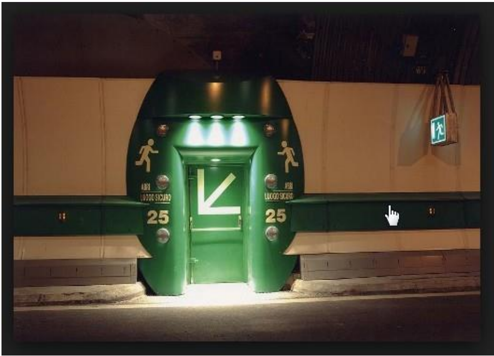
Εικόνα 6.5: Πόρτα που οδηγεί στην έξοδο κινδύνου [Πηγή: http://tunnels.piarc.org/en/structural-facilities/emergency-exits.htm ]
