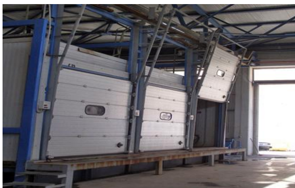
Εικόνα 6-2: Ψυκτικοί θάλαμοι προσωρινής αποθήκευσης [20].
