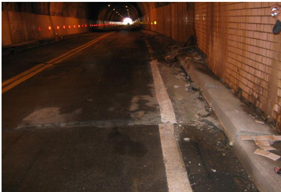
Φωτογραφία 6.15. Ζημιά στην σήραγγα Hsueh Wu. Photograph 6.15. Damage in Hsueh Wu tunnel.
