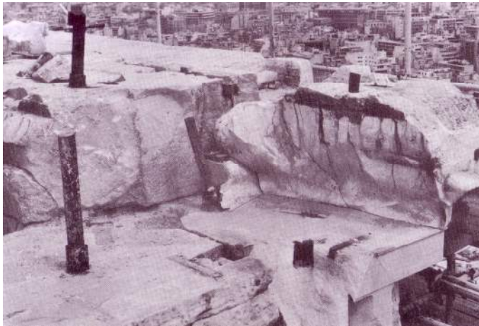
Εικ. 1.7: Καταστροφές που προκάλεσε η διάγκωση των οξειδωμένων συνδετηρίων στοιχείων της αναστήλωσης Μπαλάνου στη ΝΑ γωνία του Θρησκείου του Παρθενώνα. Διακρίνεται (δεξιά) ένα από τα θραύσματα του οριζόντιου γείσου που απεκόπη λόγω της διάγκωσης των ελασμάτων που είχαν ενσωματωθεί σε εγκοπή της πάνω επιφάνειας και της ράβδου που είχε εμφυτευτεί σε διάτρημα στο μέσο του ύψους. Διακρίνεται επίσης (κάτω στο μέσον) ότι έχει αποκοπεί τμήμα του γωνιακού τριγλύφου λόγω της διάγκωσης ενός συνδετηρίου στοιχείου αγκυρωμένου στην τραπεζοειδή εντορμία του τριγλύφου [12].
