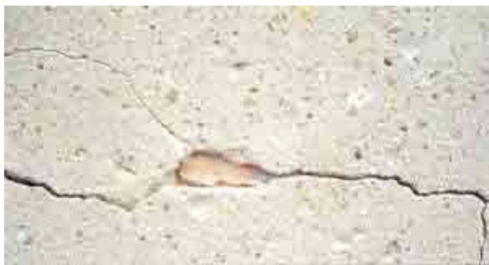
Εικόνα 3.1 Εμφάνιση ρωγμής σε σκυρόδεμα
