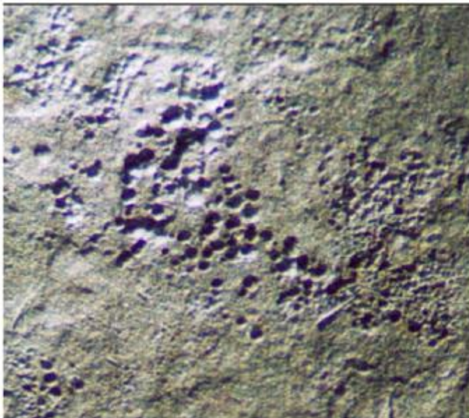
Εικόνα 4.2. Διάβρωση με βελονισμούς σε χάλυβδινη επιφάνεια μετά από έκθεση ενός έτους σε θαλάσσιο περιβάλλον.
