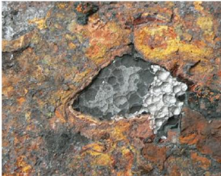
Εικόνα 4.1. Διάβρωση με βελονισμούς σε χάλυβδινη επιφάνεια μετά από έκθεση ενός έτους σε θαλάσσιο περιβάλλον.
