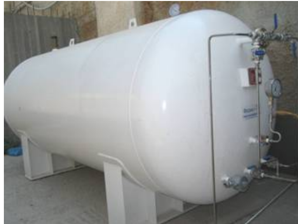
Εικόνα II.1.4: Δεξαμενή αποθήκευσης αέριου υδρογόνου
