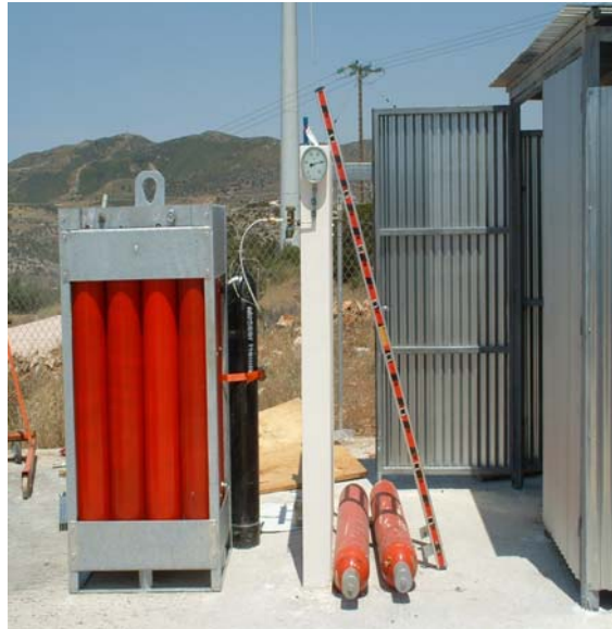
Εικόνα II.1.11: Σταθμός πλήρωσης – εμφιάλωσης υδρογόνου
