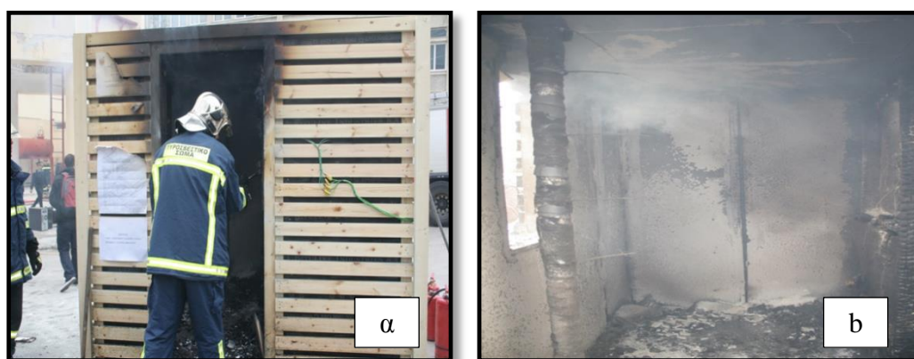
Εικόνα 11. Οικίσκος μετά την κατάσβεση της φωτιάς, α) Μπροστινή εξωτερική άποψη, β) Εσωτερικό.
