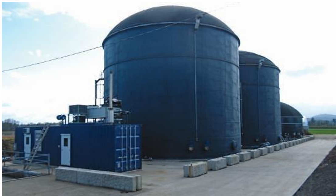
Εικόνα 5.16: Παράδειγμα χαλύβδινων αναερόβιων χωνευτήρων που φέρουν αεροστεγανό σύστημα προσωρινής αποθήκευσης (REInvest Group)
