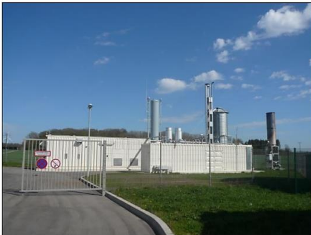
Εικόνα 5.33: Γενική απεικόνιση εγκατάστασης αναβάθμισης βιοαερίου σε βιομεθάνιο (Severn Wye Energy Agency)
