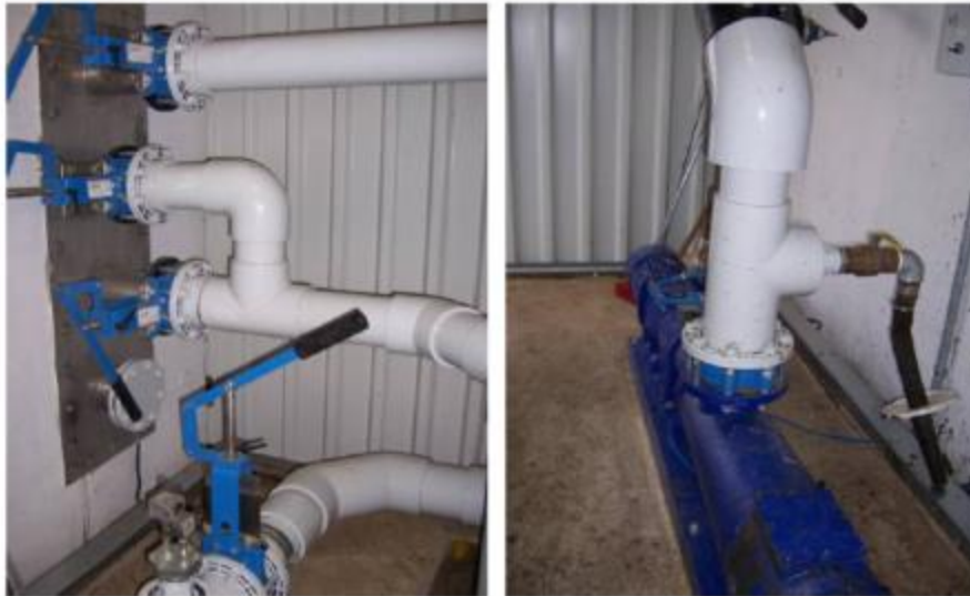
Εικόνα 5.11: Βαλβίδες διακοπής (αριστερά) και σύστημα άντλησης (δεξιά) (RUTZ., 2008)
