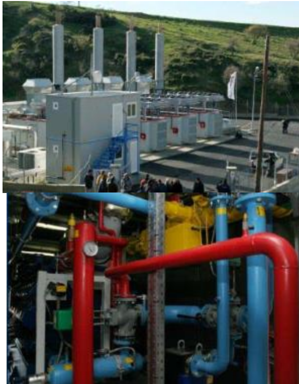
Εικόνα 4.16: Μονάδα βιοαερίου στους Ταγαράδες δυναμικότητας 5 MW ( www.helektor.gr )
