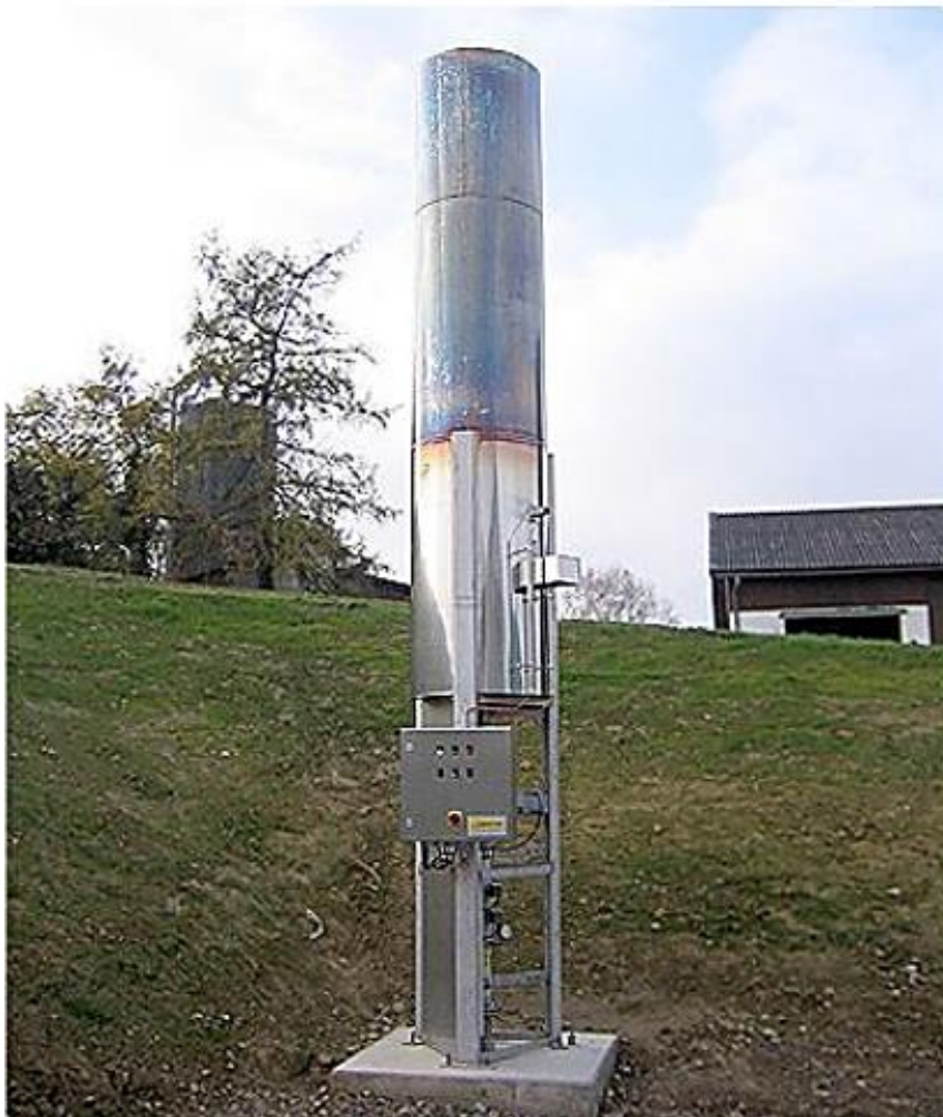
Εικόνα 5.31: Πυρσός Καύσης Περίσσειας Βιοαερίου ( www.envima.gr )
