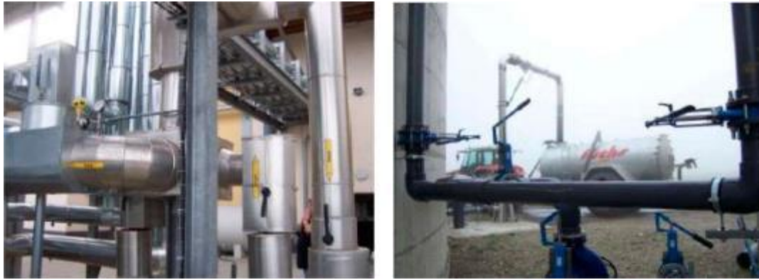
Εικόνα 5.12: Μονωμένες σωληνώσεις (αριστερά) και σωληνώσεις για βιομάζα (δεξιά) (RUTZ, 2008).
