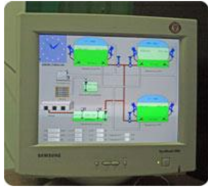
Εικόνα 5.41: Οθόνη παρακολούθησης της εγκατάστασης (Λαγούδη Α.)
