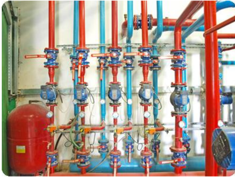
Εικόνα 5.19: Παράδειγμα σταθμού θέρμανσης χωνευτήρα (AGRINZ GmbH, 2008).
