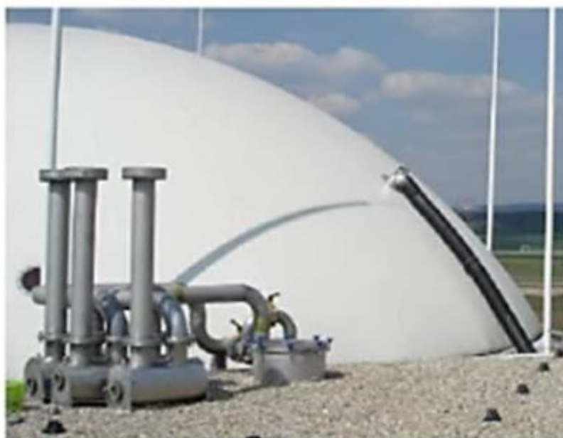
Εικόνα 5.30: Εξωτερικό σύστημα αποθήκευσης βιοαερίου (Agrinz , 2006)
