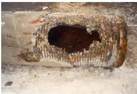
Σχήμα 1.12: Υπόγειος μεταλλικός σωλήνας νερού 36
