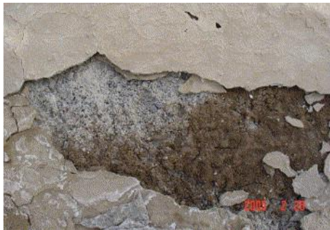
Σχήμα 2.21: Σκυρόδεμα με προσβολή θεικών αλάτων 114
