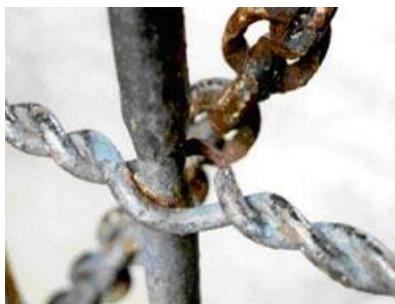
Σχήμα 1.23: Διάβρωση λόγω τριβής μεταλλικού στύλου και μεταλλικών καλωδίων εκτεθειμένων σε αέρα. Και τα δύο τμήματα έχουν υποστεί διάβρωση λόγω τριβής 47
