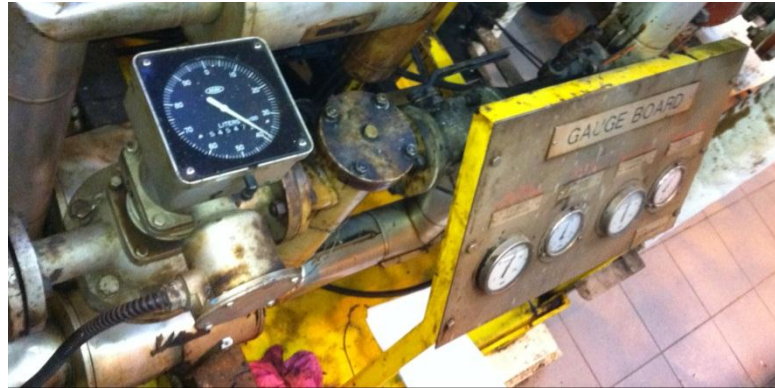
Εικόνα 8-2 Ροόμετρο καυσίμου και ενδείξεις πίεσης και θερμοκρασίας καυσίμου.
