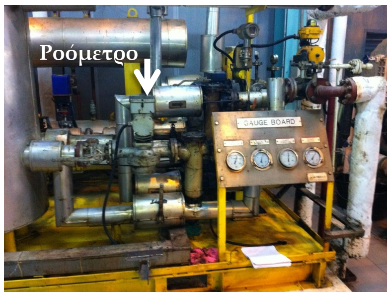
Εικόνα 8-1. Απεικόνιση του εγκατεστημένου ροόμετρου και οι ενδείξεις πίεσης και θερμοκρασίας.
