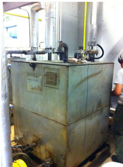
Εικόνα 8-3 Δεξαμενή επιστροφών του καυσίμου.
