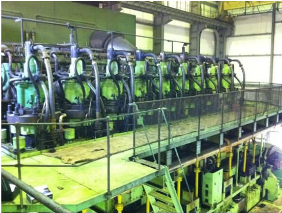
Εικόνα 5-16 Κινητήρας 9RTAF58 ονομαστικής ισχύος 11MW, όπου εγκαταστάθηκε η συσκευή μέτρησης της ροπής.
