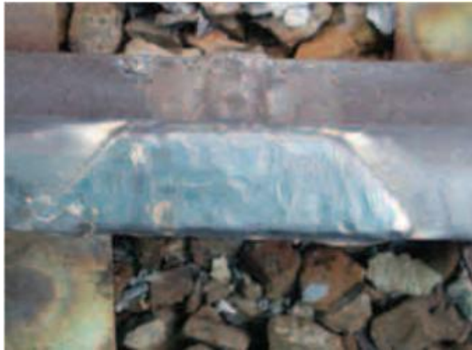
Σχήμα 4.8(α): Μεταλλική επιφάνεια μετά από αναγόμωση, χωρίς λείανση
