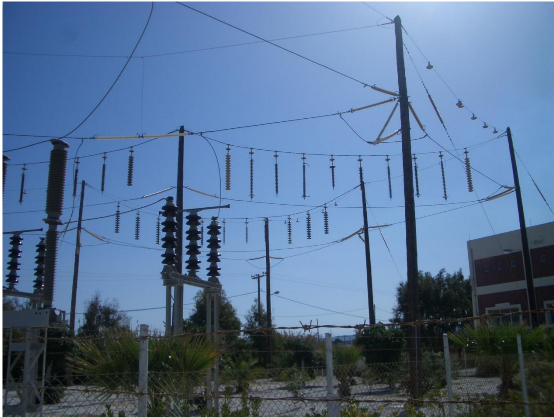
4. Μονωτήρες αναρτήσεως (τμήμα 150kV).
