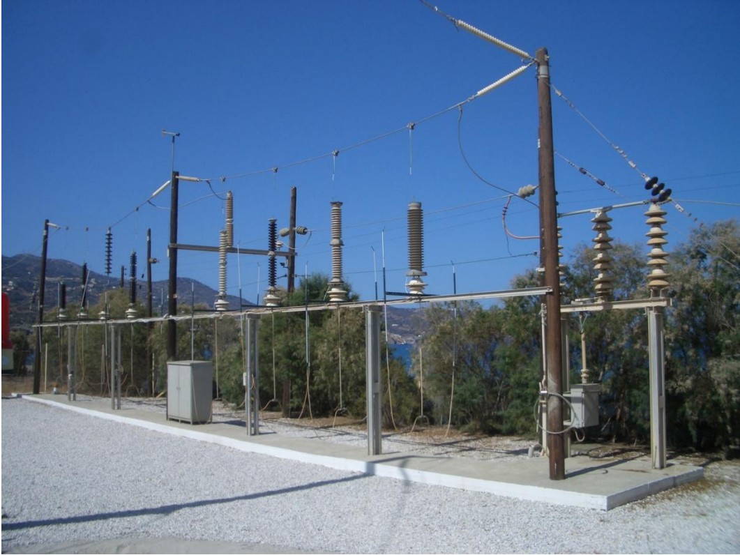
1. Μονωτήρες στηρίξεως (τμήμα 150kV)
