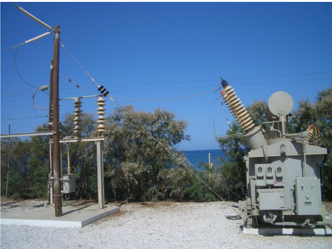
2. Μετασχηματιστής ανύψωσης τάσης 20/150kV
