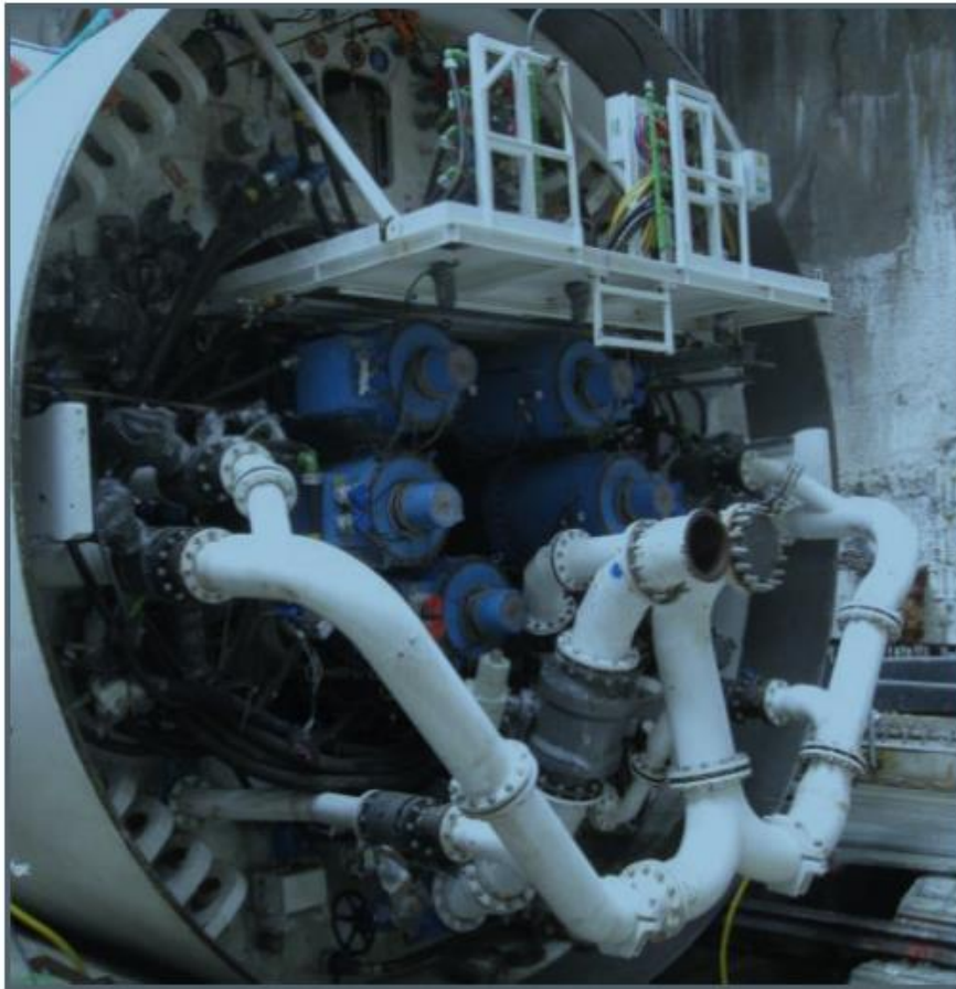
Εικόνα 1-29: Το σύστημα σωληνώσεων αναρρόφησης του εδαφικού υλικού με το μπετονίτη και τροφοδοσίας του αιωρήματος μπετονίτη στο εσωτερικό ενός μηχανήματος slurry [9]
