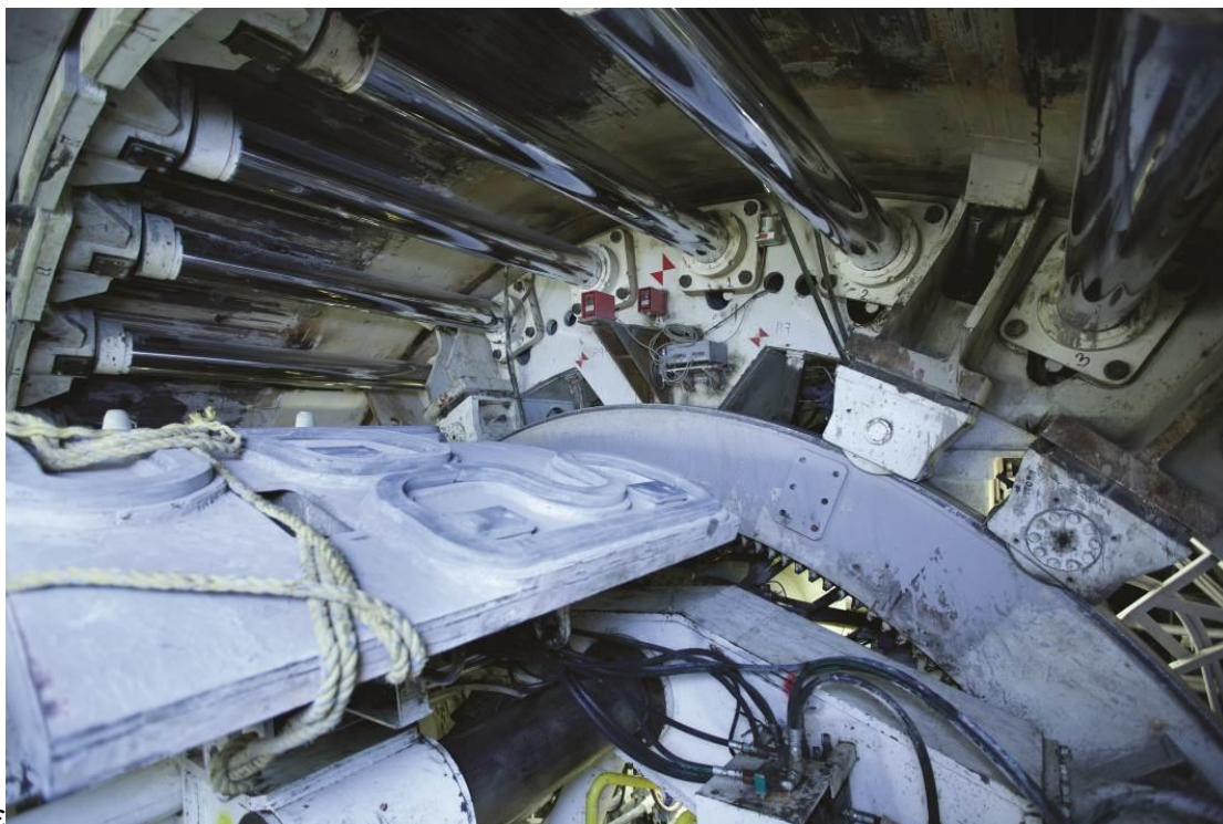
Εικόνα 1-14: Σημείο του εξοπλισμού όπου είναι τοποθετημένα τα υδραυλικά έμβολα ώθησης [9]
