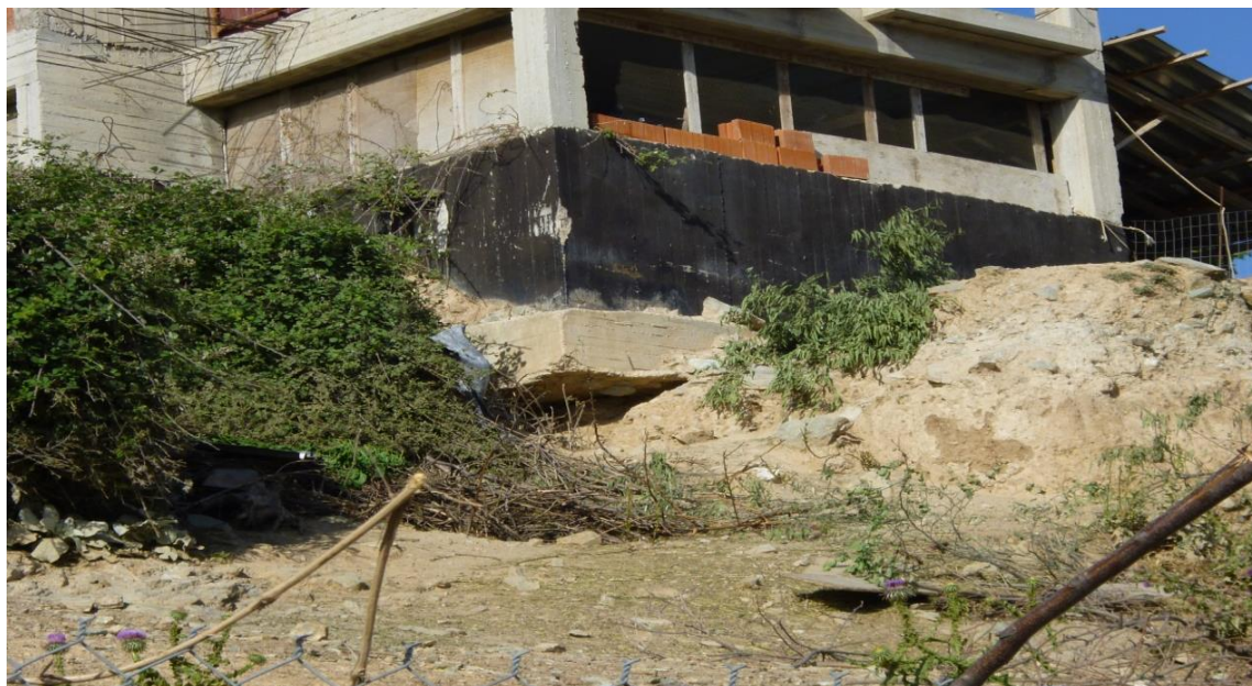
Εικόνα 4.8 Ζημιές σε οικοδομή μετά από κατολίσθηση στην περιοχή
