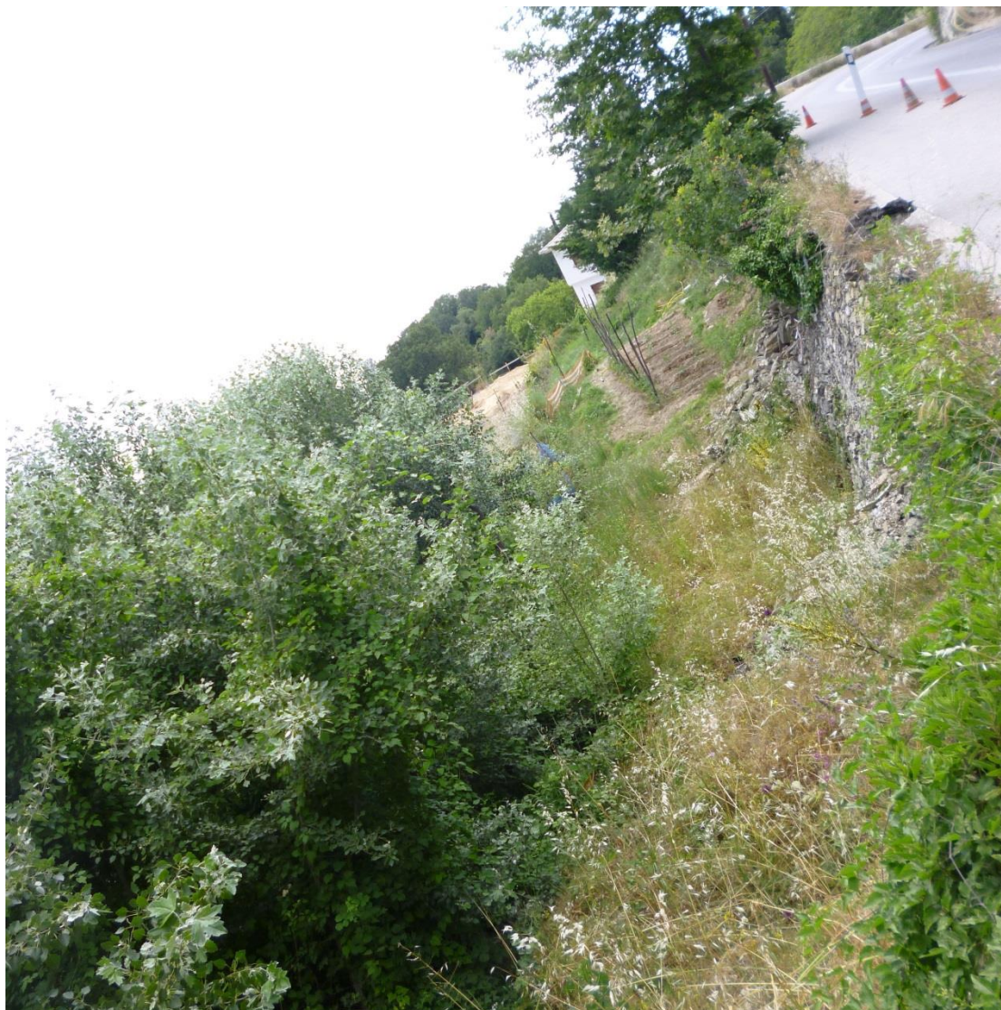
Εικόνα 4.7 Κατολίσθηση εκατέρωθεν του οδικού δικτύου
