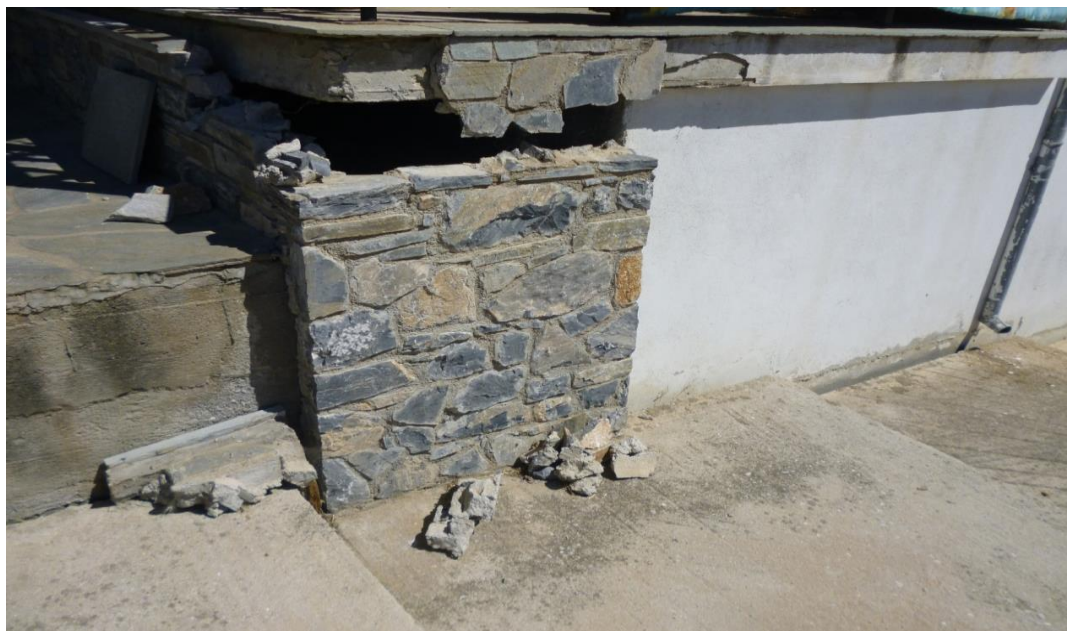
Εικόνα 4.10 Υψηλού κινδύνου ζημιές σε οικία της περιοχής μελέτης
