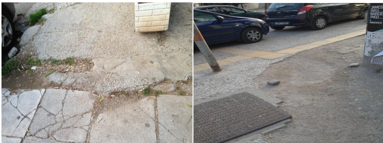
Εικόνα 5.16: Κατάσταση πεζοδρομίων επί της οδού Μεταξά
