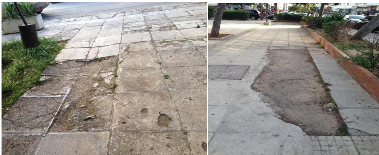
Εικόνα 5.15: Κατάσταση πεζοδρομίων στο κέντρο της Γλυφάδας
