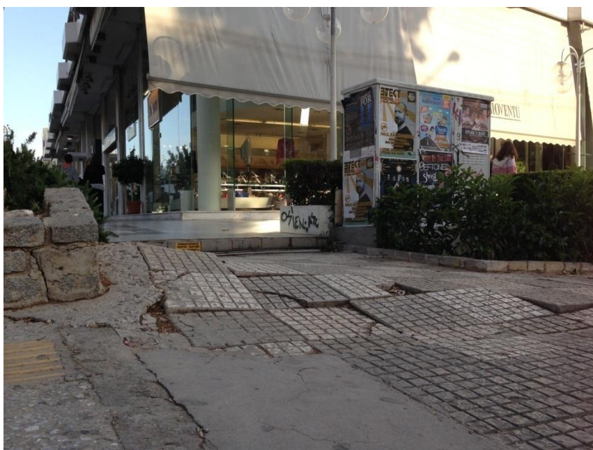
Εικόνα 5.13: Κατάσταση πεζοδρομίου στην οδό Μεταξά
