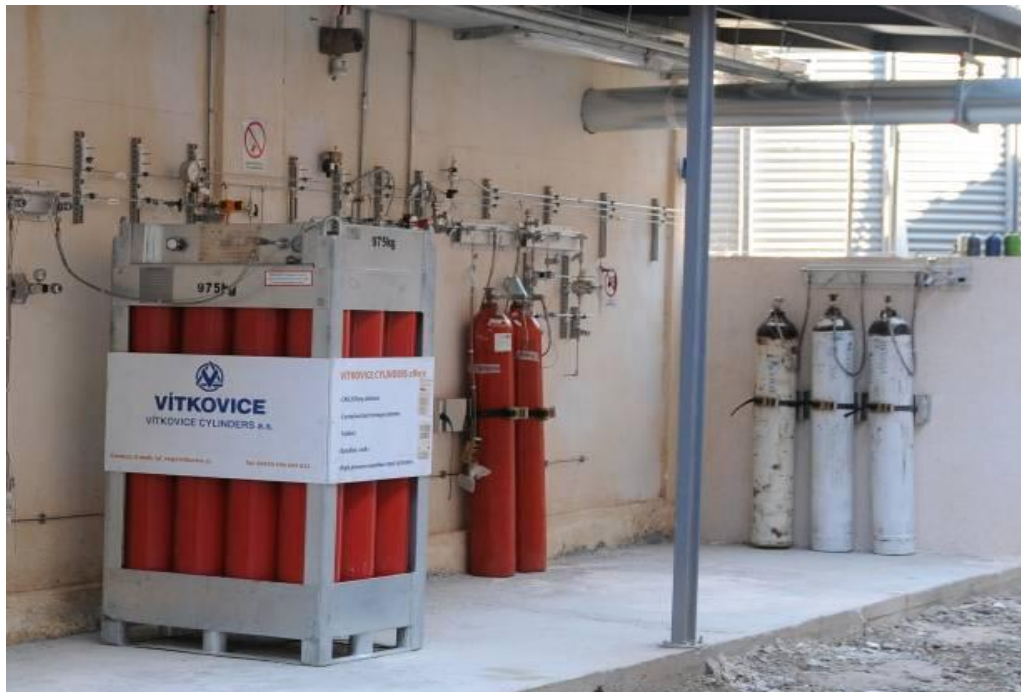
Εικόνα 35: Φωτογραφία του συστήματος αποθήκευσης H 2 .
