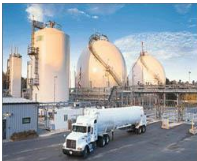
Εικόνα18: Εργοστασιακές εγκαταστάσεις (δεξαμενές) αποθήκευσης H 2 . (Πηγή: Wikipedia)
