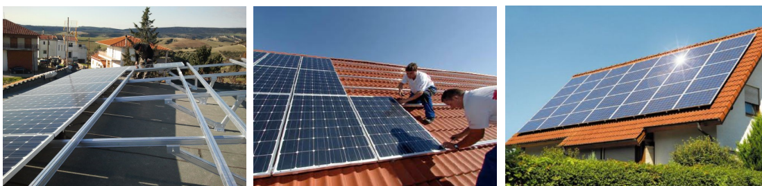
Σχήμα 5.13: Εγκαταστάσεις φωτοβολταϊκών σε στέγες
