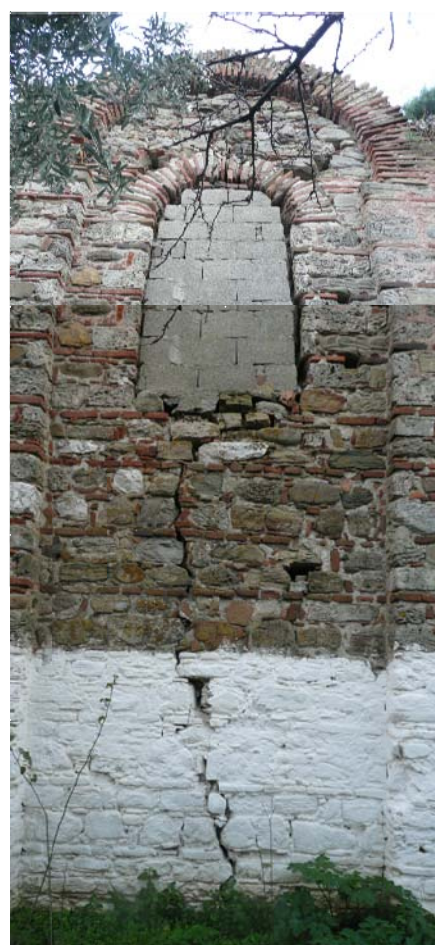
Εικ. 03.2 Διαμπερής ρηγμάτωση του βορείου τοίχου στο τμήμα που ορίζεται από την εγκάρσια κεραία του Ναού. Η ρηγμάτωση εμφανίζεται από τη στάθμη θεμελίωσης και φθάνει ως και τη θολοδομία, διασχίζοντας το άνοιγμα που έχει φραγεί εκ των υστέρων μετσιμεντολίθους.
