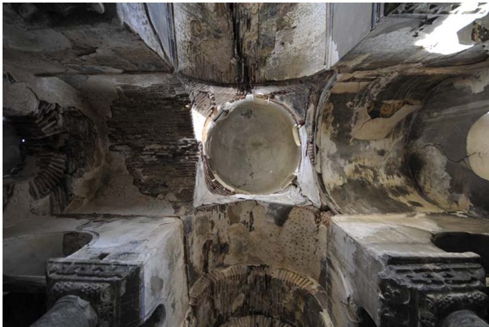
Εικ. 3.13 : Ρηγματώσεις στη θολοδομία
