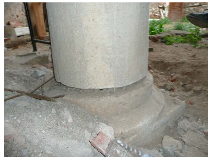
Εικ. 05.3 Άποψη βάσης έδρασης του δυτικού κίονα της νότιας κίονοστοιχίας. Εμφανίζεται διάνοιξη του αρμού έδρασης λόγω στροφής του μέλους περί οριζόντιο άξονα, αλλά όχι στροφή της βάσης.
