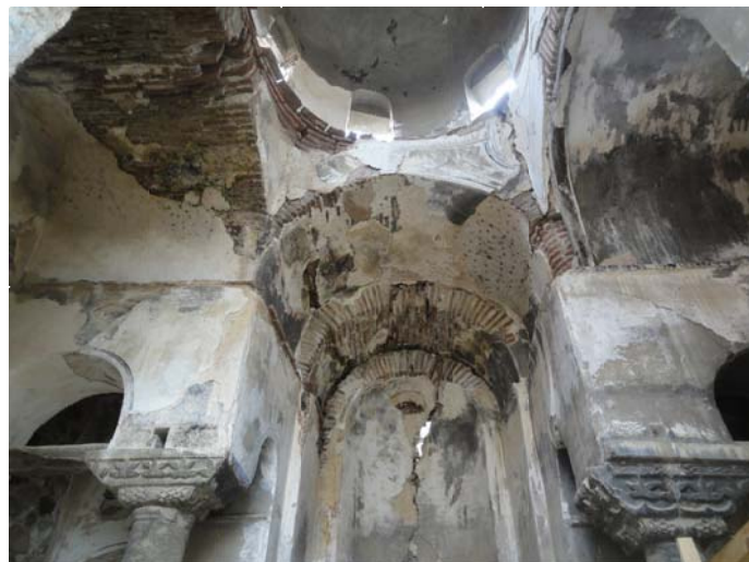
Εικ. 06.1 Άποψη ανατολικής εσωτερικής όψης θολοδομίας από το κέντρο του Ναού. Απώλεια κονιαμάτων και οπτοπλίνθων στην περιοχή της κλείδας του βορείου τόξου.
