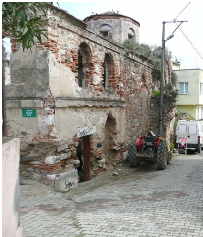
Εικ. 04.1 Άποψη του νοτίου τοίχου με το σωζόμενο τμήμα μίας εκ των τριών τοξωτών αντηρίδων που τον στήριζαν. Εμφανής η απόπλυση κονιαμάτων και η απώλεια οπτοπλίνθων στο νεώτερο τμήμα, καθώς επίσης και η βλάβη που έχει αναπτυχθεί άνωθεν της θολοδομίας.
