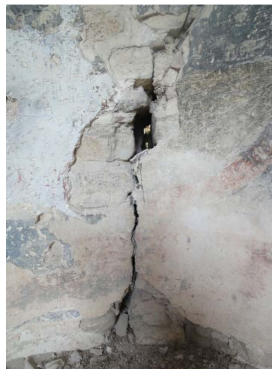
Εικ. 06.5 Εσωτερική άποψη διαμπερούς ρηγμάτωσης κόγχης ιερού στη στάθμη του δαπέδου του ιερού.
