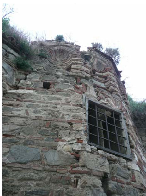
Εικ. 02.3 Άποψη κόγχης ιερού. Διαμπερής ρηγμάτωση από τη στάθμη θεμελίωσης έως και το τεταρτοσφαιρικό στέγαστρο, με μέγιστο εύρος περί τα 70 mm.
