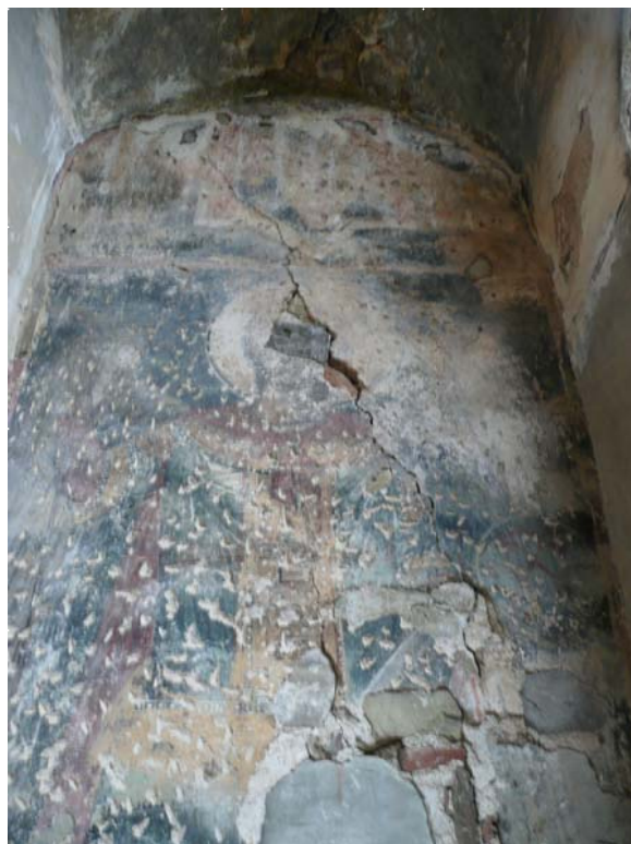
Εικ. 05.1 Διαμπερής ρηγμάτωση του νοτίου τοίχου στο τμήμα δυτικά της εγκάρσιας κεραιάς του ναού. Απώλεια μέρους της αγιογραφίας.
