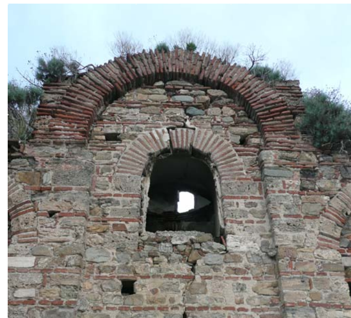
Εικ. 04.2 Διαμπερή ρηγμάτωση του νοτίου τοίχου στο τμήμα που ορίζεται από την εγκάρσια κεραία του Ναού. Η ρηγμάτωση εμφανίζεται από τη στάθμη θεμελίωσης και φθάνει ως και τη θολοδομία. Η ρηγμάτωση διέρχεται από το τοξωτό υπέρθυρο προκαλώντας αποκόλληση της περιοχής της κλείδας.
