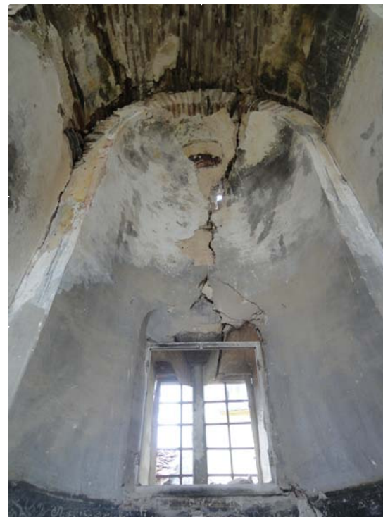
Εικ. 06.4 Εσωτερική άποψη διαμπερούς ρηγμάτωσης κόγχης ιερού. Η ρηγμάτωση εκτείνεται ως το τεταρτοσφαίριο στέγασης της κόγχης και επικοινωνεί με τη ρηγμάτωση στη διεύθυνση ανατολής- δύσης κατά το μέσον του κεντρικού τόξου.
