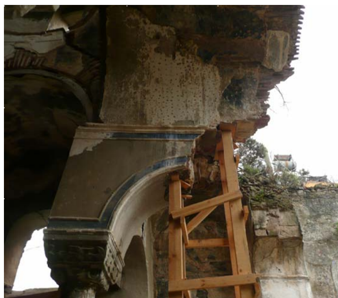
Εικ. 05.2 Η περιοχή της θολοδομίας περί τον δυτικότερο εκ των δύο εναπομειναντων κίωνων της νότιας τοξοστοιχίας. Στα δεξιά της φωτογραφίας φαίνεται η προσωρινή σωστική υποστήλωση έναντι του ετοιμόροπου τμήματος του σταυροθολίου. Το υπόλοιπο τμήμα κατέρρευσε όταν αφαιρέθηκε ο ένας εκ των τριών κίωνων.
