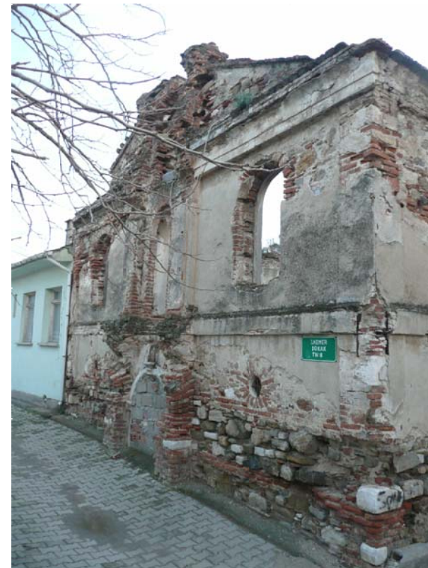
Εικ. 02.4 Άποψη δυτικού τοίχου. Στο μέσον κατά το μήκος του τοίχου φαίνονται τα ίχνη του μη σωζομένου κωδωνοστασίου. Εμφανίζονται τα μεταλλικά στοιχεία σύνδεσης μεταξύ του δυτικού και του νοτίου τοίχου. Επίσης, φαίνεται η απώλεια τμήματος των επιχρισμάτων, των αρμολογημάτων και γωνιολίθων.
