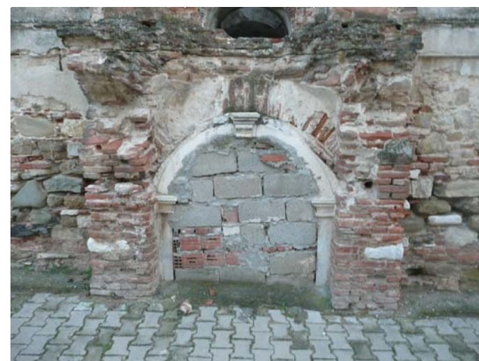
Εικ. 02.5 Η φραγμένη και επιχωμένη είσοδος στο μέσον του δυτικού τοίχου και τα εναπομείναντα τμήματα των πεσσών του μη σωζομένου κωδωνοστασίου. Εμφανής η απόπλυση των αρμολογημάτων στη ζώνη πλησίον του εδάφους.
