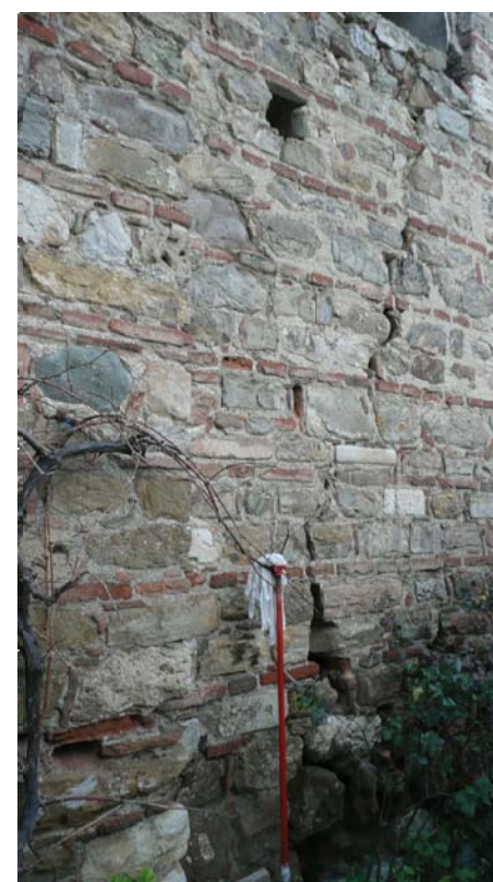
Εικ. 04.3 Διαμπερή ρηγμάτωση του νοτίου τοίχου στο τμήμα που ορίζεται από την εγκάρσια κεραία του Ναού. Άποψη ρηγμάτωσης πλησίον θεμελίωσης έως και τη στάθμη του ανοίγματος.
