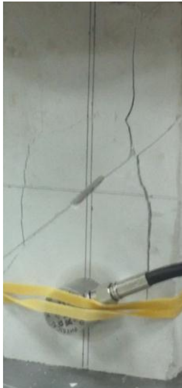
Φωτογραφία 6.47: Διεύρυνση των ρωγμών.
