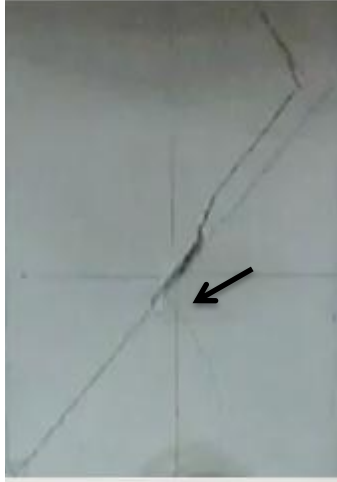
Φωτογραφία 6.72: Αρχική τροχία ρωγμής.
