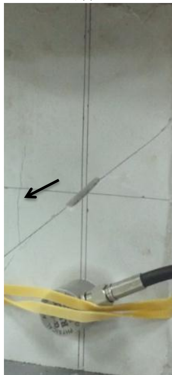
Φωτογραφία 6.45:Εφελκυστική ρωγμή.
