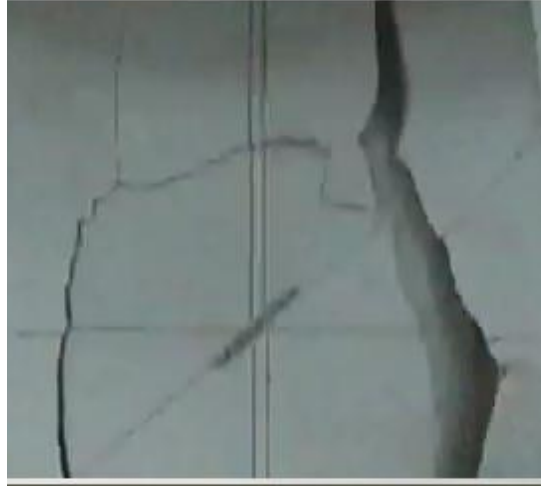
Φωτογραφία 6.48: Αστοχία δοκιμίου και δημιουργία αποφλοιώσεων.
