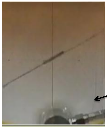
Φωτογραφία 6.29:Ξεκίνημα ρωγμής.
