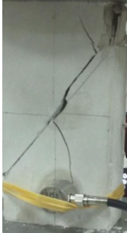
Φωτογραφία 6.70:Ολίσθηση στο επίπεδο ασυνέχειας.
