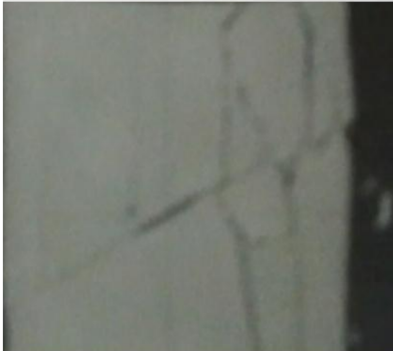
Φωτογραφία 6.14: Διεύρυνση ρωγμών και θραύση δοκιμίου.
