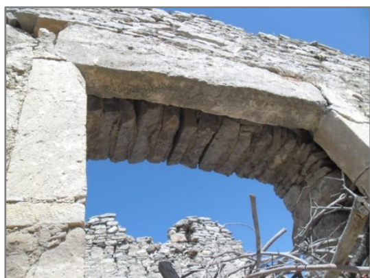
Εικ. 3.12. Λίθινο πλαίσιο ορθογωνικής εξωτερικής πόρτας. Εσωτερικά το ανώφλι διαμορφώνεται με λίθινη καμάρα (χαμηλό τόξο).
