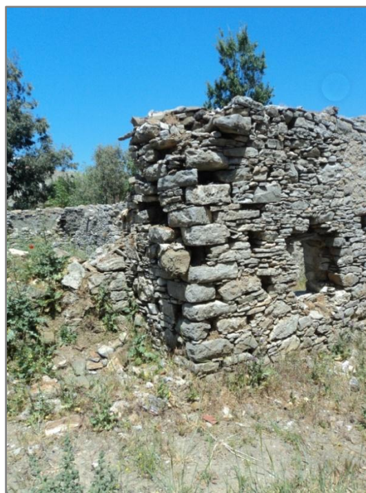
Εικ. 3.45. Κατεστραμμένη τοιχοποιία στη γωνία εξωτερικών διασταυρούμενων τοίχων.
