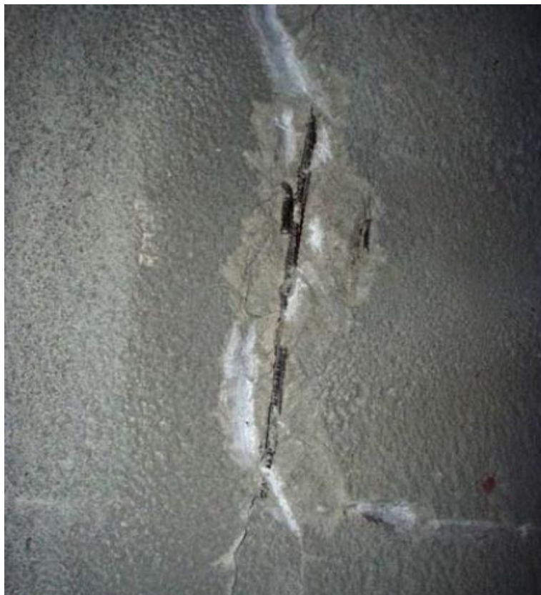
Σχήμα 3.17 Ρηγμάτωση εκτοξευόμενου σκυροδέματος γύρω από δικτυωτό πλαίσιο
