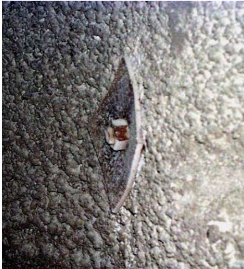
Σχήμα 3.18 Παραμορφωμένη πλάκα αγκυρίου (face plate) λόγω αστοχίας της υποστήριξης
