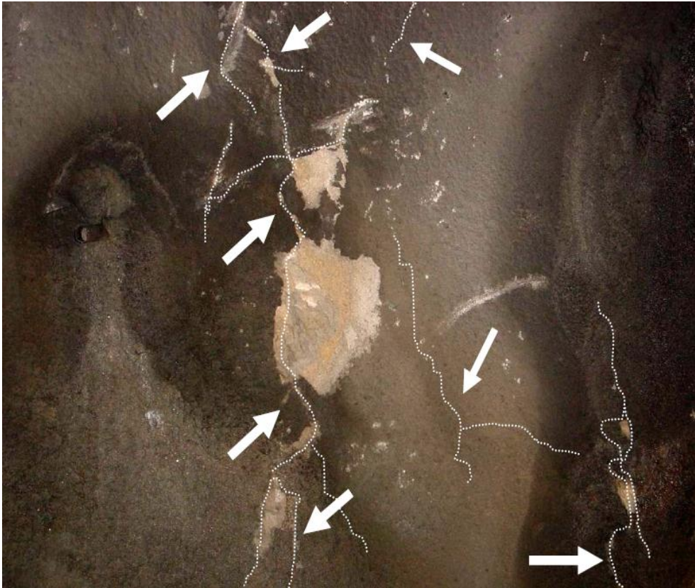
Σχήμα 3.16 Ανάπτυξη των ρωγμών στο εκτοξευόμενο σκυρόδεμα της άνω ημιδιατομής
