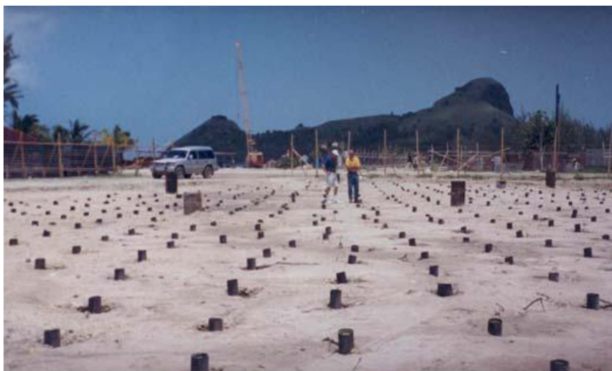
Εικόνα 4-6 Φωτογραφία από την εγκατάσταση στραγγιστηρίων πριν από την εγκατάσταση των σωλήνων στο Hyatt Regency Hotel and Casino (Rollins et al., 2004)
