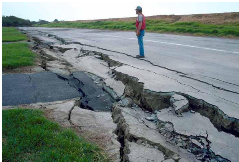
Εικόνα 2-1 Πλευρική εξάπλωση μετά το σεισμό στη Loma Prieta της Καλιφόρνια
