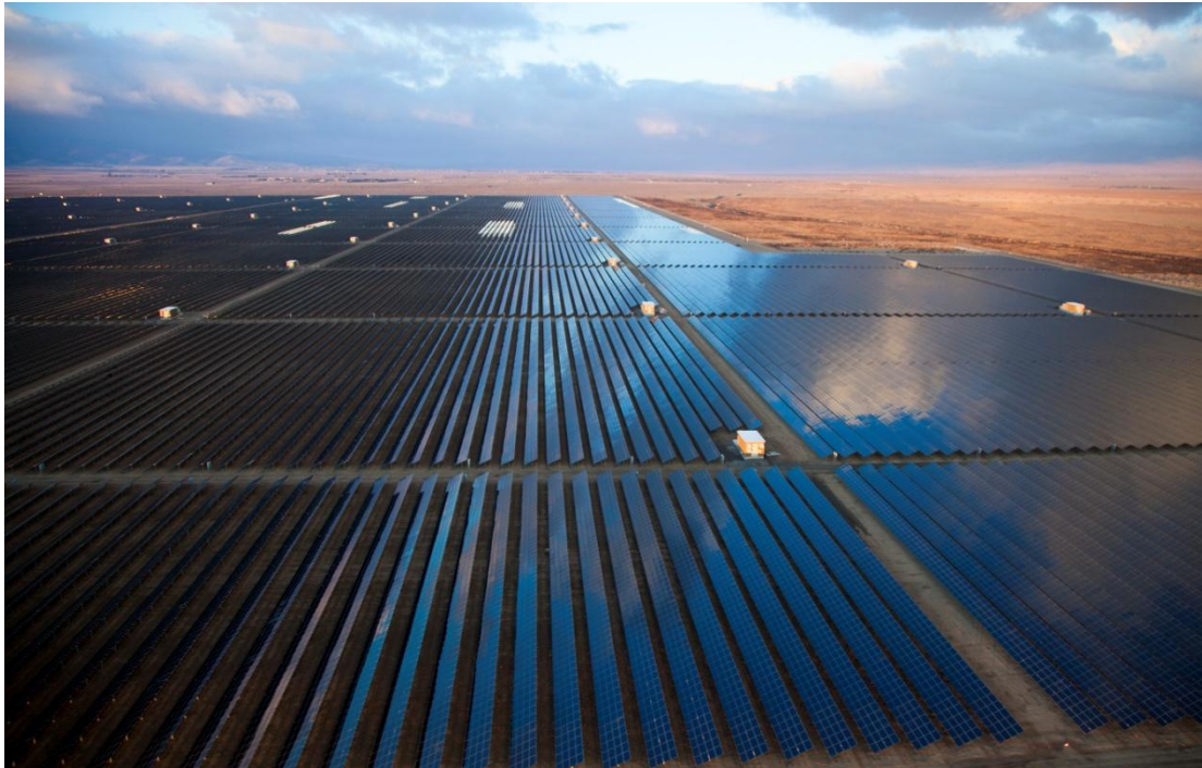
Εικόνα 7.1 Copper Mountain Solar Facility στη Nevada με εγκατεστημένη ισχύ 150MW.
