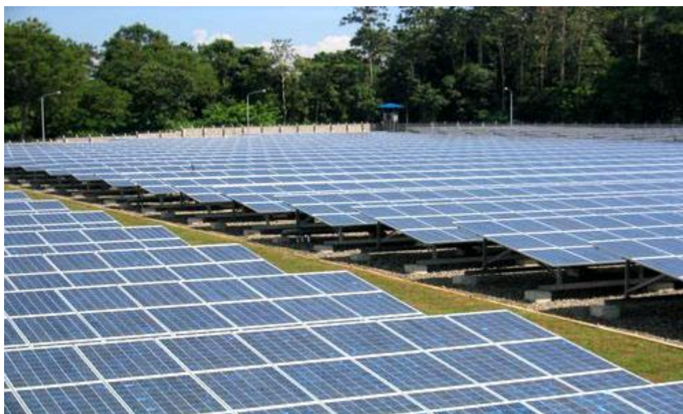
Φωτογραφία 2.6: Φωτοβολταϊκός σταθμός ισχύος 100 kW διασυνδεδεμένος με το σύστημα [39]
