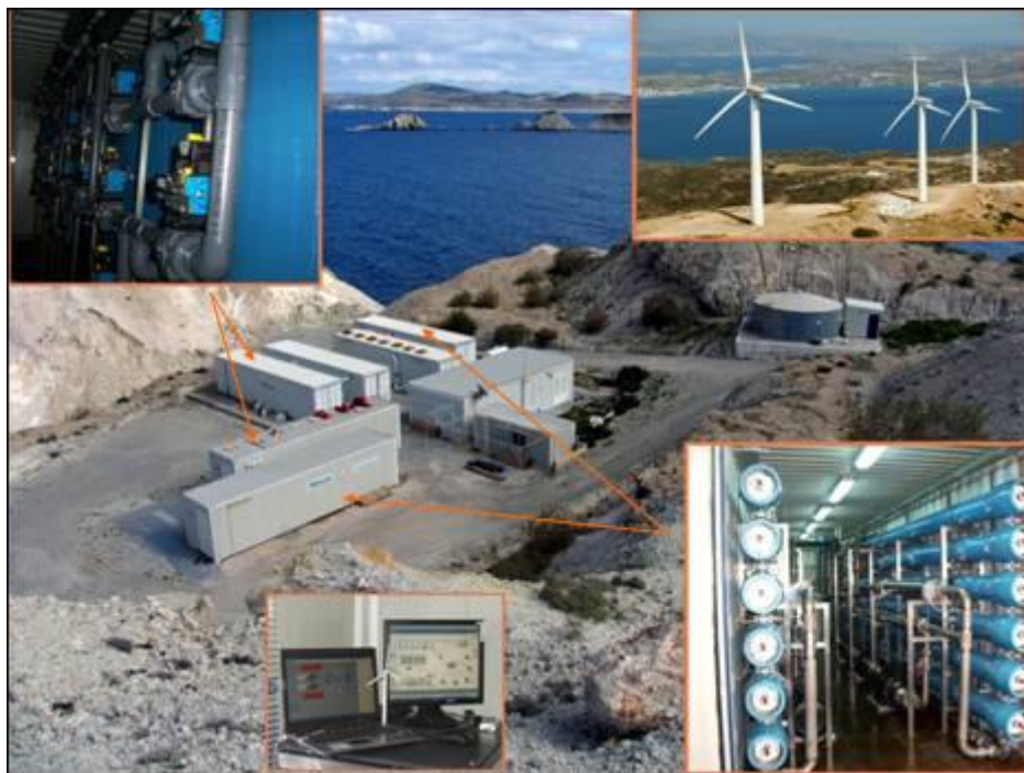
Φωτογραφία 1.1: Εγκατάσταση αφαλάτωσης στη Μήλο [7]
