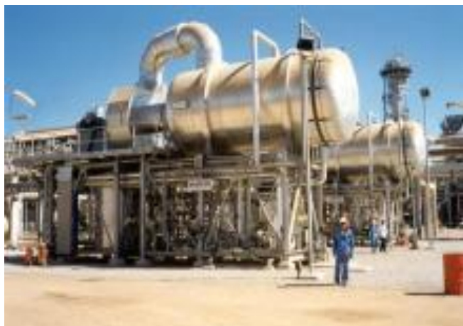
Φωτογραφία 2.3: Εγκατάσταση επανασυμπίεσης ατμών [5]
