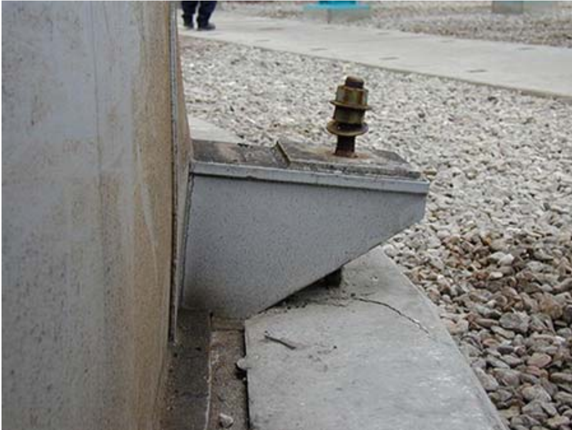
Εικόνα 1.4 Αστοχία της αγκύρωσης που περιλαμβάνει επιμήκυνση βλήτρου, παραμόρφωση κελύφους και θραύση δακτυλίου από σκυρόδεμα (2001 magnitude-8.4 Peru Earthquake)
