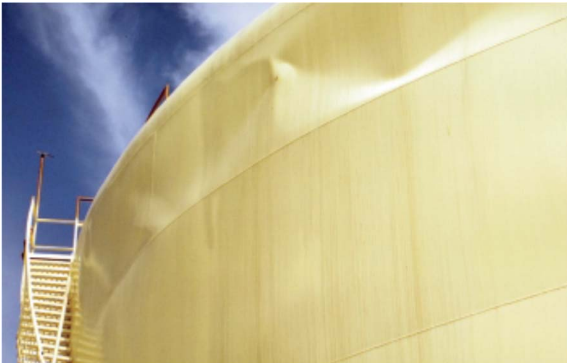
Εικόνα 1.2 Λυγισμός της κορυφής του κελύφους δεξαμενών (Northridge earthquake, California)
