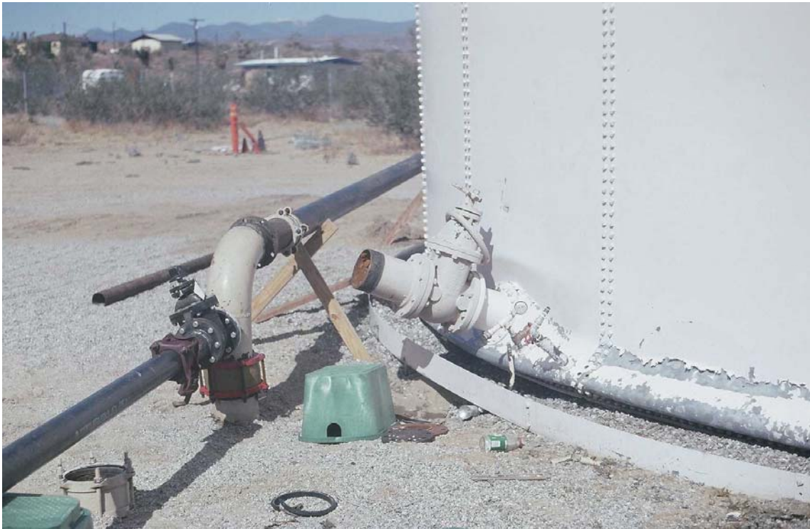
Εικόνα 1.3 Θραύση σύνδεσης σωληνώσεων και λυγισμός τύπου “elephant-foot” λόγω ανύψωσης της βάσης
