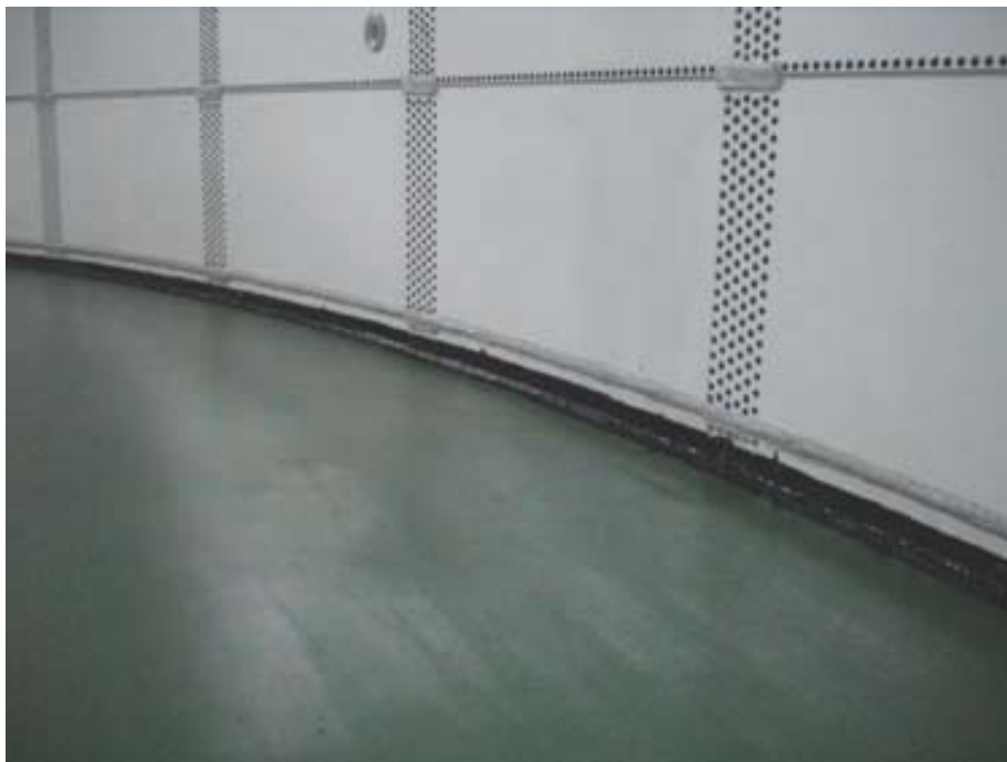
Εικόνα 1.8 Αποψη εσωτερικού κοχλιωτής μεταλλικής δεξαμενής
