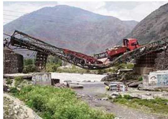
Εικόνα 19: Κατάρρευση γέφυρας στην Ινδία
