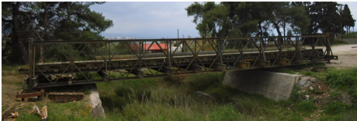
Φωτογραφία 10: Εγκατεστημένος φορέας απλός-απλός 60 ποδών
