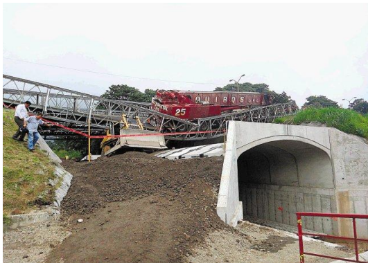
Εικόνα 18: Κατάρρευση γέφυρας στη Κόστα Ρίκα το 2012
