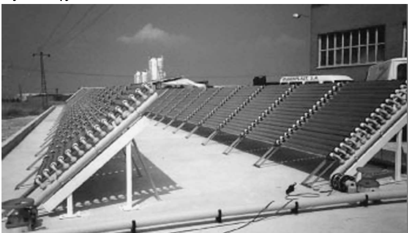
Εικόνα 65 Οι εγκαταστάσεις της Plataforma Solarde Almeri'a στην Ισπανία που έχουν γίνει σημείο αναφοράς σε παγκόσμιο επίπεδο.
