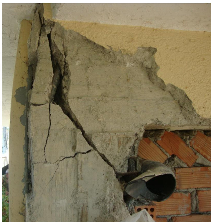
Εικόνα 4.1 Διατμητική αστοχία υποστυλώματος
