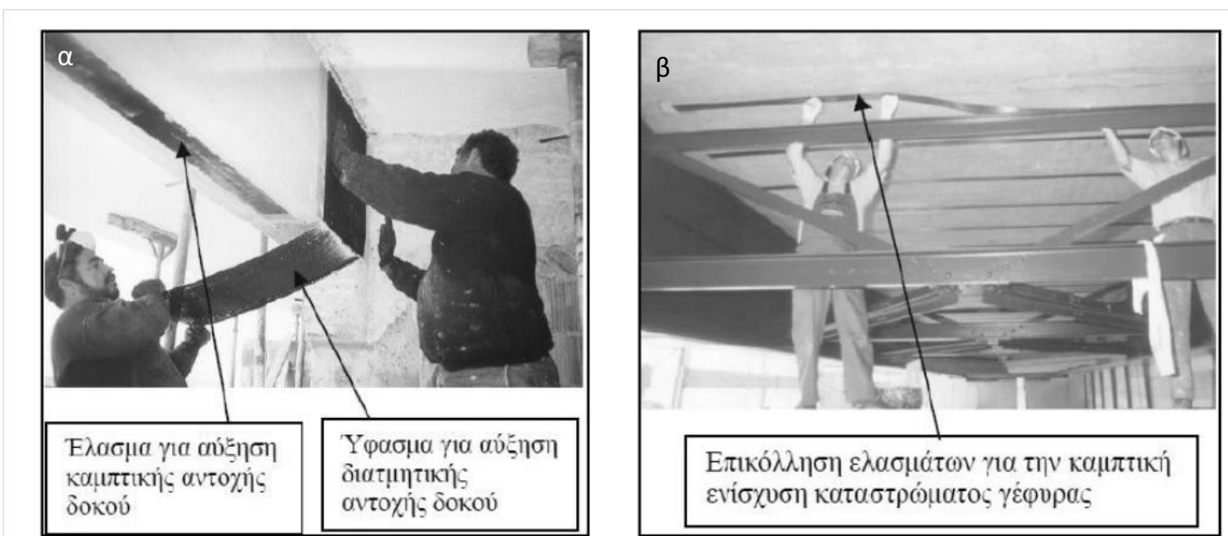
Σχήμα 2.29 Παραδείγματα εφαρμογής σύνθετων υλικών σε έργα ενισχύσεων α) Αύξηση φέρουσας ικανότητας στοιχείων β) Ενίσχυση γεφυρών έναντι σεισμικών φορτίων
