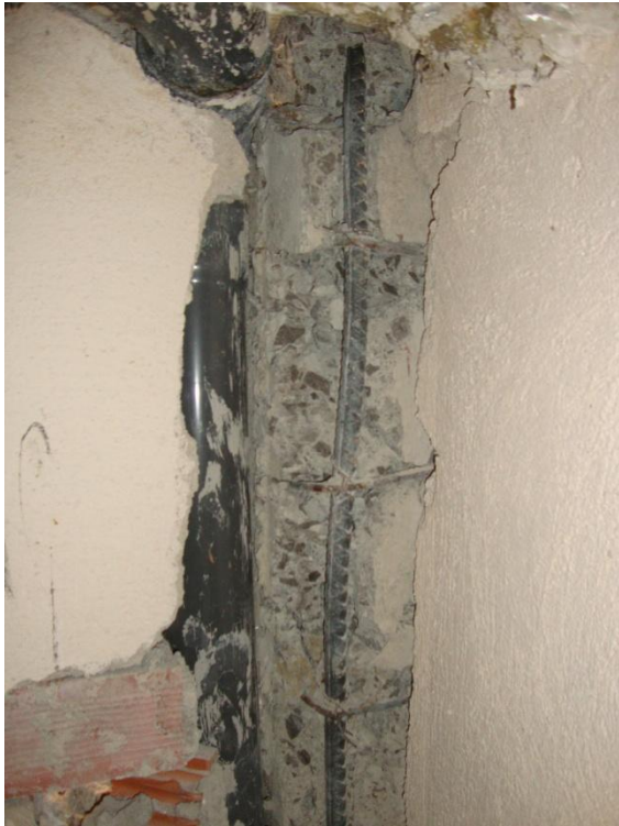
Εικόνα 4.2 Ανεπαρκείς λεπτομέρειες όπλισης κρίσιμων περιοχών
