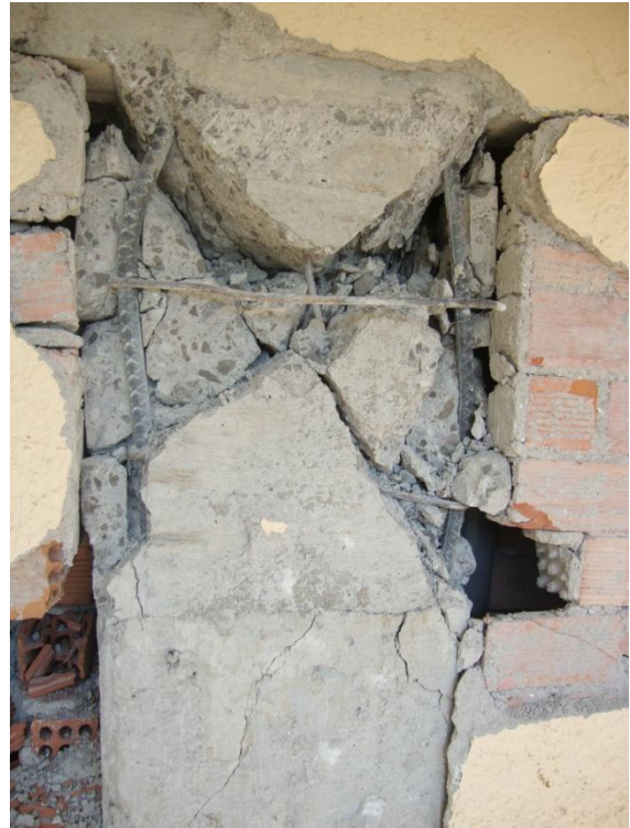
Εικόνα 4.3 Δημιουργία κοντού υποστυλώματος
