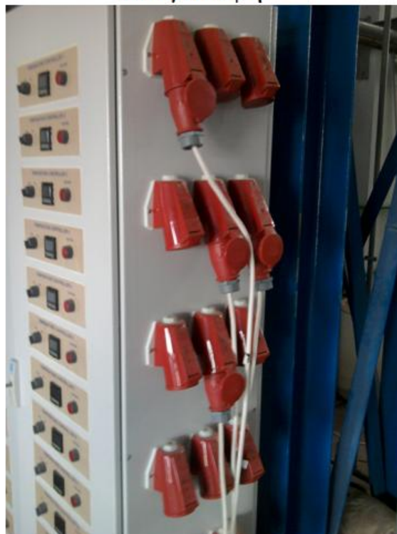
Εικόνα 3.5. Πίνακας ελέγχου (πλάγια όψη)
