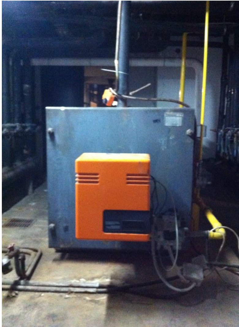
Εικόνα 1.14: Λέβητας Κτιρίου 'Ο'
