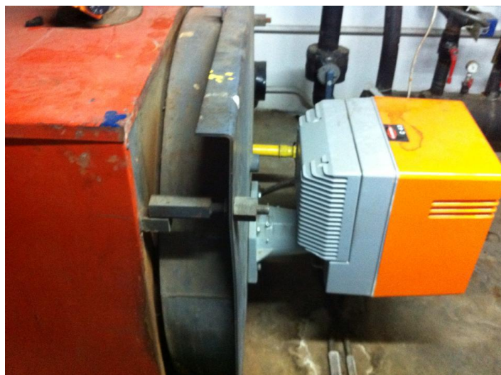
Εικόνα 1.15: Καυστήρας του λέβητα
