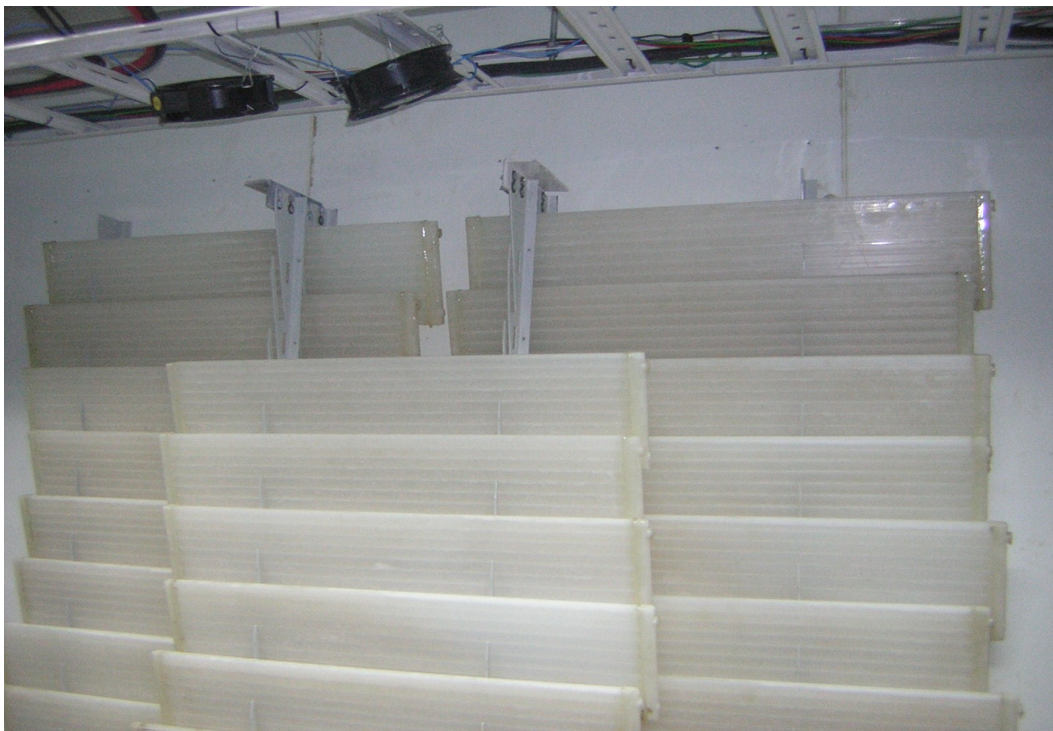
ΕΙΚΟΝΑ 4.9.1.3: PCM ΕΓΚΑΤΕΣΤΗΜΕΝΟ ΣΤΟ ΚΑΤΑΦΥΓΙΟ TELECOM ΣΕ 29C
