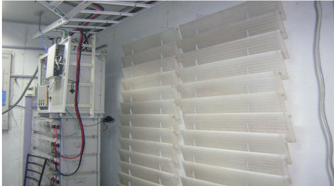
Εικόνα 5.9.1.1 : PCM εγκατεστημένο στο καταφύγιο Telecom για τους AC-Back-up σε 29C
