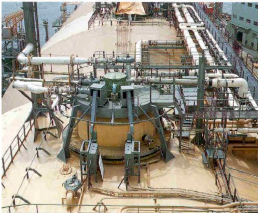
Εικόνα 4.2 Στην παραπάνω εικόνα φαίνεται το κάλυμμα της δεξαμενής, ο θόλος και οι σωληνώσεις του φορτίου.
