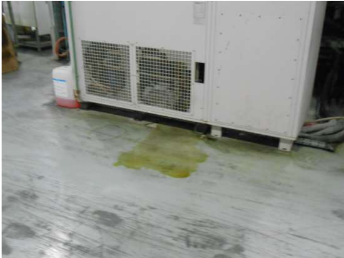
Εικόνα 39: Διαρροή λαδιών από ψυγείο εκτυπωτικής μηχανής
