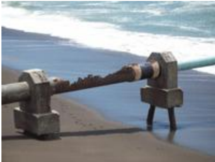
Εικόνα: Διάβρωση σωληνώσεως λόγω θαλασσινού περιβάλλοντος
