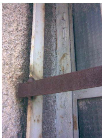
Εικόνα: Ατμοσφαιρική Διάβρωση
