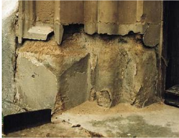
Εικόνα: Χημική Διάβρωση
