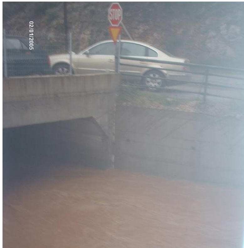
Εικόνα 6.1 Η θέση στη Γύρα Στεφάνης στις 22/02, την ημέρα μέγιστης απορροής του επεισοδίου 7. Στην εικόνα φαίνεται η αρκετά ανυψωμένη στάθμη του νερού σε σύγκριση και με την πλήρη διατομή του οχετού στην Εικόνα 3.2.
