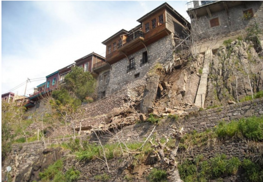
Εικόνα 2 - Κατάπτωση βραχοτεμαχών σε πρανές στο χωριό Μόλυβος Μυτιλήνης (Μάρτιος 2014), ( www.emprosnet.gr )
